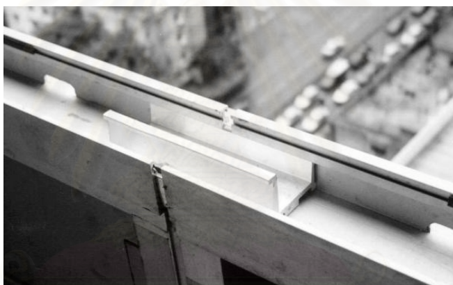
แผนภาพที่ 4.23 แสดงการติดตั้ง Gutter Spice เพื่อยึดแผงสองแผงไว้ด้วยกัน
