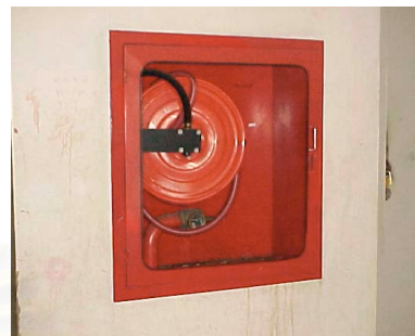
ภาพที่ 6.63 แสดงอุปกรณ์ฉุกเฉิน (2)
