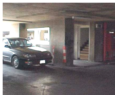
ภาพที่ 6.52 แสดงลานจอดหน้าบันไดหนีไฟ (2)
