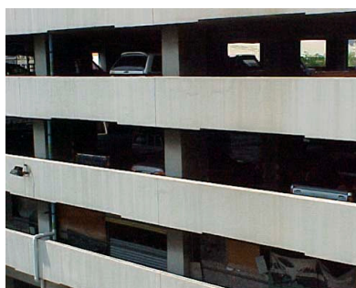
ภาพที่ 6.51 แสดงสภาพอาคารจอดรถ (1)
