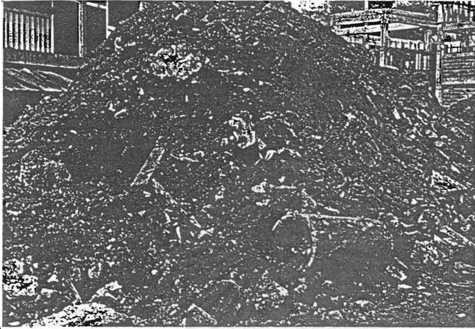
รูปที่ ข.1 แสดงกองเศษสิ่งก่อสร้างรวมที่รอการขนไปกำจัด
