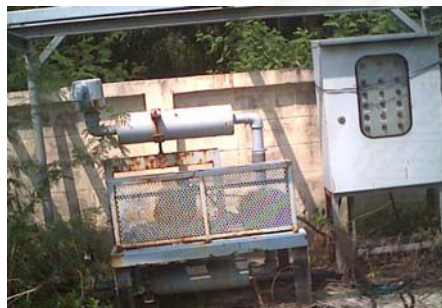
ภาพที่ 4-7 เครื่องควบคุมบ่อน้ำบาดน้ำเสีย
