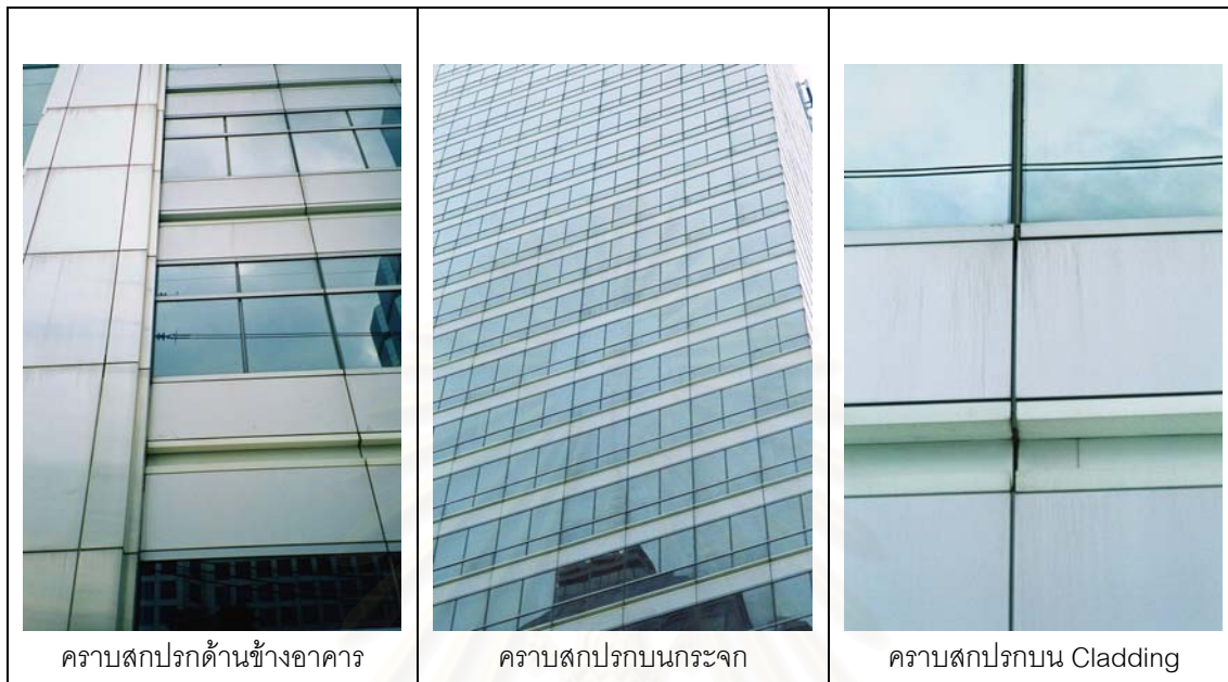
รูปภาพ 3-14 แสดงสภาพปัญหาของอาคาร Bangkok City Tower ในช่วงที่ 3
