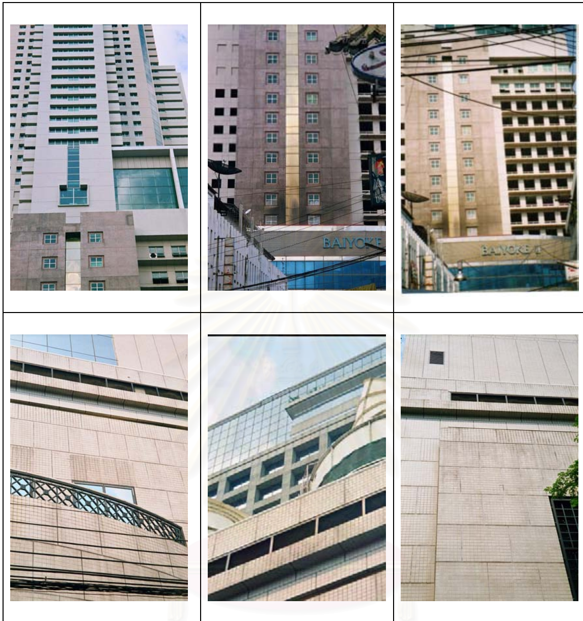
รูปภาพ 4-18 แสดงสภาพปัญหาคราบสกปรกบริเวณอาคารซึ่งติดตั้ง Cooling Tower และ Generator
