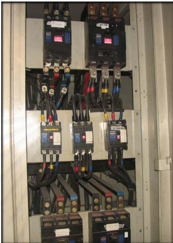
รูปที่ 5.8 Breakerที่อยู่ในตู้ MDB
