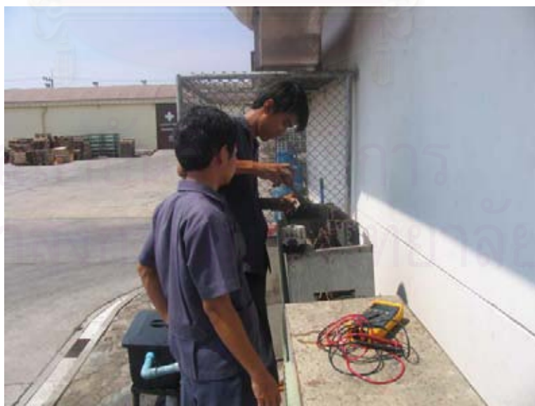
รูปที่ 5.21 เตรียมทำการวัดค่าต่างๆของเครื่องปรับอากาศ
