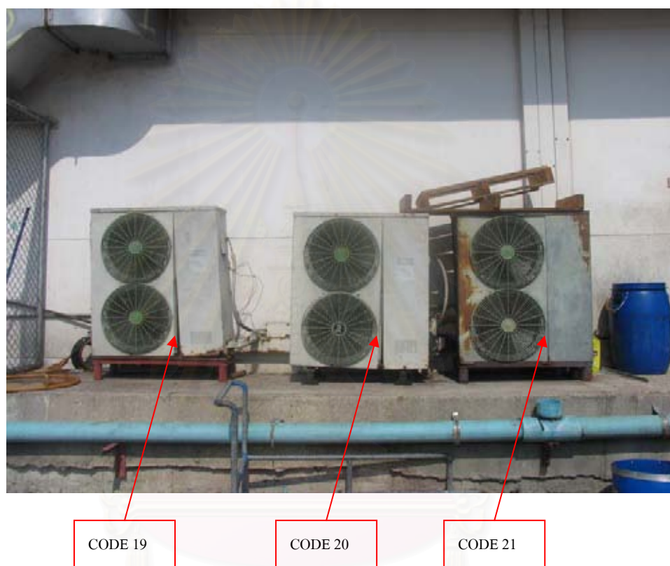
รูปที่ 5.22 สภาพ Condensing Unit ห้องอบรม
