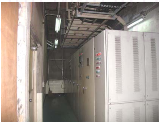
รูปที่ 5.7 ตู้ Main Distribution Board (MDB)
