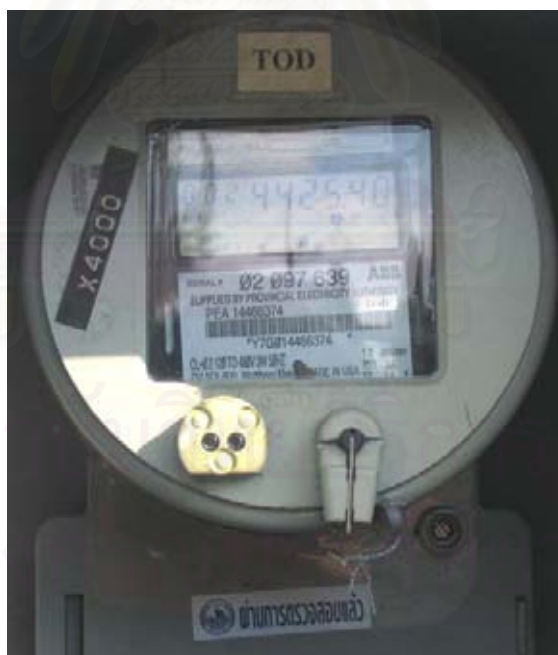
รูปที่ 5.5 มิเตอร์บันทึกการใช้พลังงานไฟฟ้าชนิด TOD
