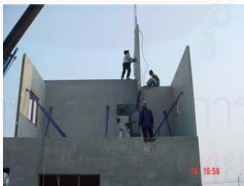
รูปที่ 4.10 แสดงการติดตั้งชิ้นส่วนคอนกรีตสำเร็จรูปที่ไม่เป็นไปตามขั้นตอน
