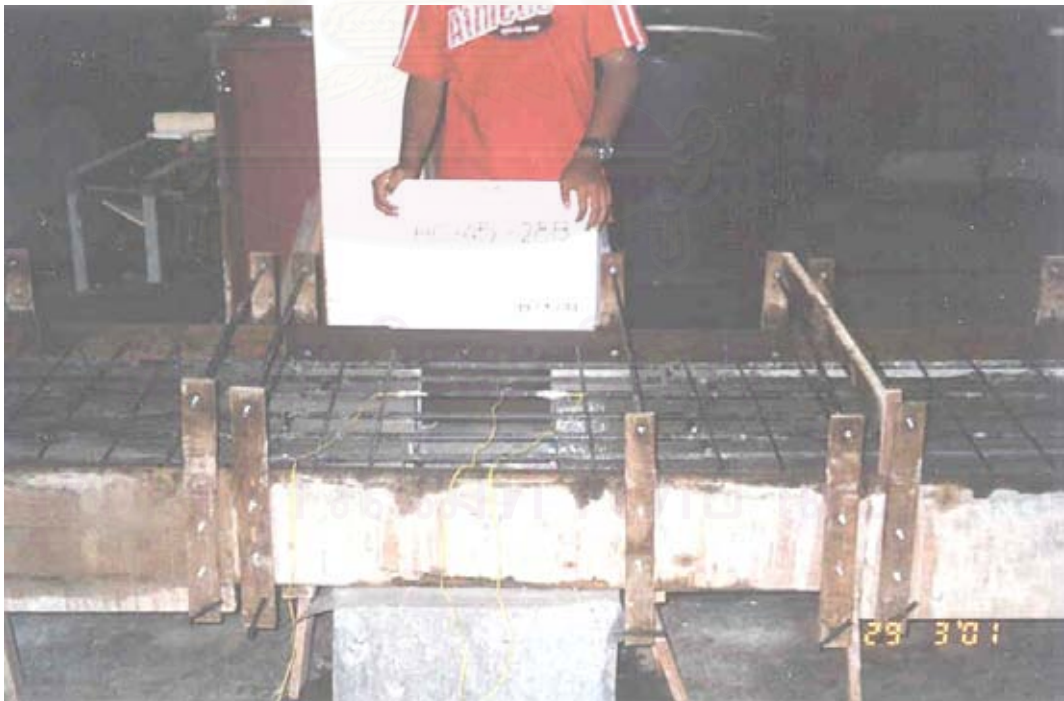
รูปที่ 3.31 การติดมาตรวัดความเครียด (Strain gauge) แบบใช้ไฟฟ้าบนเหล็กเสริม
