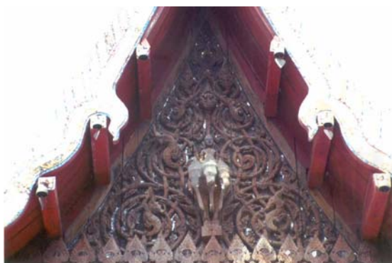
ภาพที่ 134 หน้าบันวัดบึง (ด้านสกัดด้านหน้า) จ.นครราชสีมา
