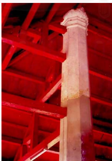
ภาพที่ 71 ลักษณะโครงสร้างหลังคาเครื่องประดับแบบมีไม้ยึดโครง รูปทรง หลังคาแบบมุขโถง (หลังคาจั่วกันสาด หลังคาจั่วเปิด) วัดพุทธโส สวรรวิชัย
