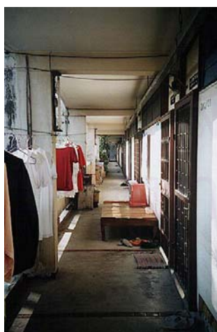
ภาพที่ 4.49 ระเบียบทางเดินในอาคาร มีการนำเอาเสื้อผ้าออกมาตาก
