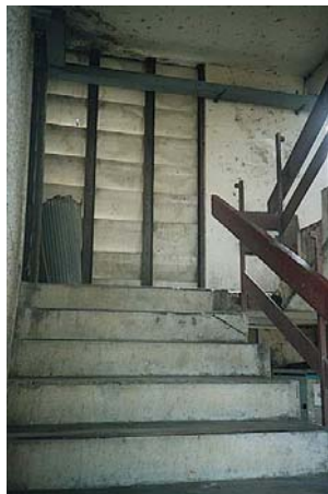
ภาพที่ 4.47 สภาพบันไดในแฟลตอาคาร 4
