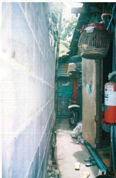
รูปภาพ 4.25 แสดงระบบการป้องกันอัคคีภัยชุมชน โดยการติดตั้งถังดับเพลิงตามจุดต่างๆ
