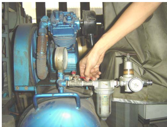
รูปที่ 4.16 แสดงวิธีการเปิดวาล์วจ่ายอากาศอัด
