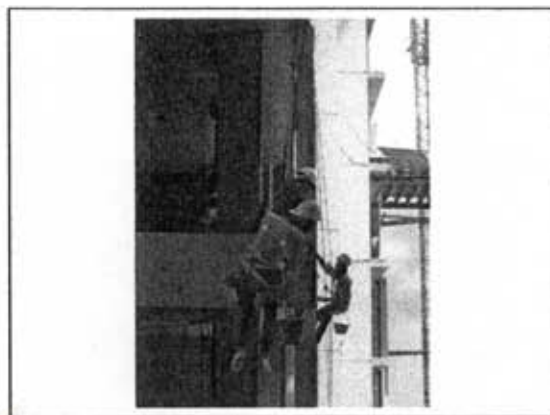
ภาพที่ 5.69 แสดงการโรยตัวแต่งผิวผนังค.ส.ล.สำเร็จรูปหลังจากการติดตั้ง
