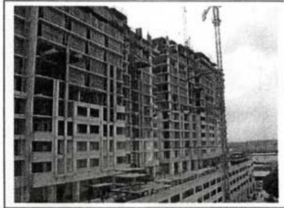
ภาพที่ 5.97 แสดงปัญหาของลำดับการติดตั้งแผ่นผนังค.ส.ล. สำเร็จรูปที่ไม่สอดคล้องกับลำดับ งานโครงสร้าง
