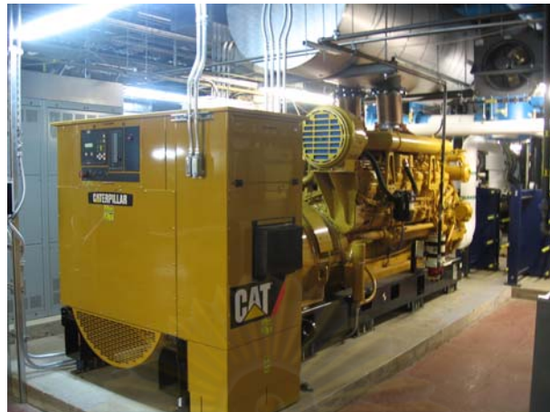
รูปที่ 2.10 เครื่องกำเนิดไฟฟ้า
