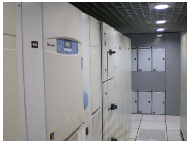
รูปที่ 2.8 ระบบสำรองไฟฟ้าอัตโนมัติ
