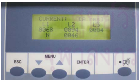
รูปที่ 3 งานในส่วนของระบบสำรองไฟฟ้าอัตโนมัติ
