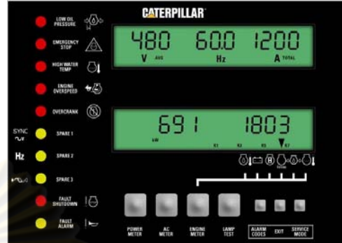
รูปที่ 4 งานในส่วนของระบบเครื่องกำเนิดไฟฟ้า
