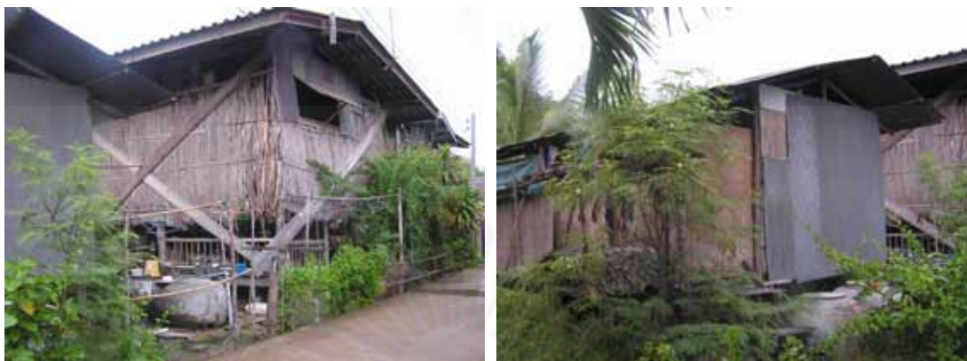
รูปที่ 4.8 อาคารพื้นถิ่นที่พบในพื้นที่ มีความทรุดโทรมและต้องการการปรับปรุง
