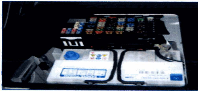
รูปที่ 3.5 อุปกรณ์ไฟฟ้า
