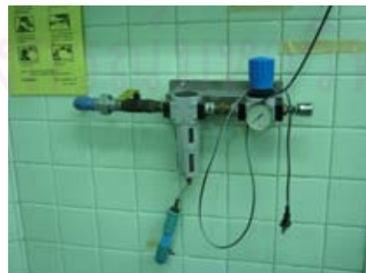
ภาพที่ 4.99 แสดง รูป Power pipeline พร้อม วาล์ว เปิด-ปิด ที่มา: ภาพถ่ายโดยผู้วิจัย
