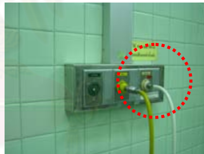
ภาพที่ 4.98 แสดง ตำแหน่งระบบ Scavenging ภายในห้องผ่าตัดกระดูกโรงพยาบาล D
