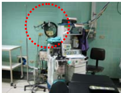
ภาพที่ 4.127 แสดง ตำแหน่ง Power Pipeline พร้อม วาล์ว เปิด-ปิด
