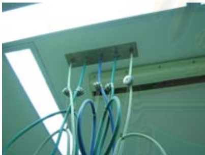
ภาพที่ 4.97 แสดง ตำแหน่ง Pipeline ภายในห้องผ่าตัดกระดูกโรงพยาบาล D
