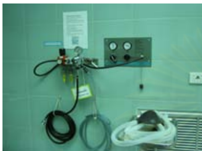
ภาพที่ 4.25 แสดง Power pipeline
