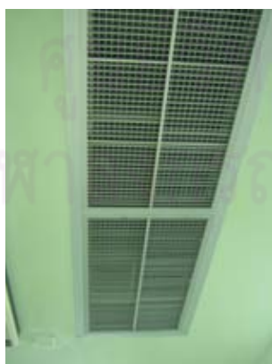
ภาพที่ 4.72 แสดง ระบบปรับอากาศ กรองด้วย Hepa filter
