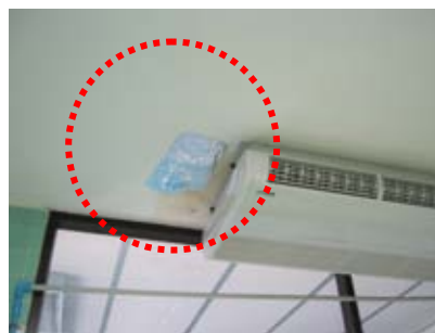
ภาพที่ 4.114 บริเวณฝ้าเพดาน ชำรุด ภายในห้องผ่าตัดกระดูก
