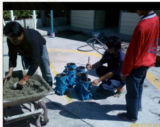
รูปที่ 3.45 การเทคอนกรีตลงในแบบหล่อลูกปูน
