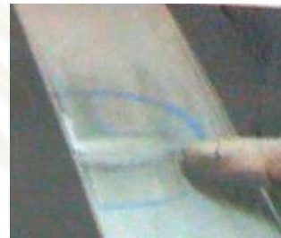
รูปที่ 3.26 บริเวณ Sash บุบ
