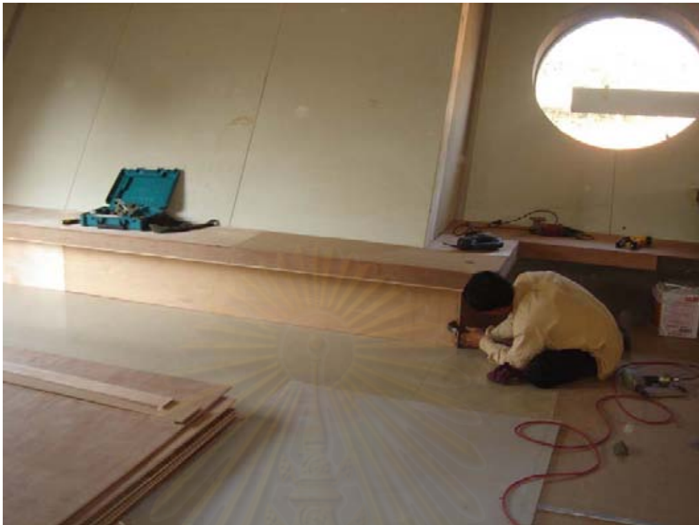
ภาพที่ 4-36 ครุภัณฑ์ติดถาวร ภายในอาคารเน้นการสามารถใช้สอยอาคารๆได้ทุกส่วน
