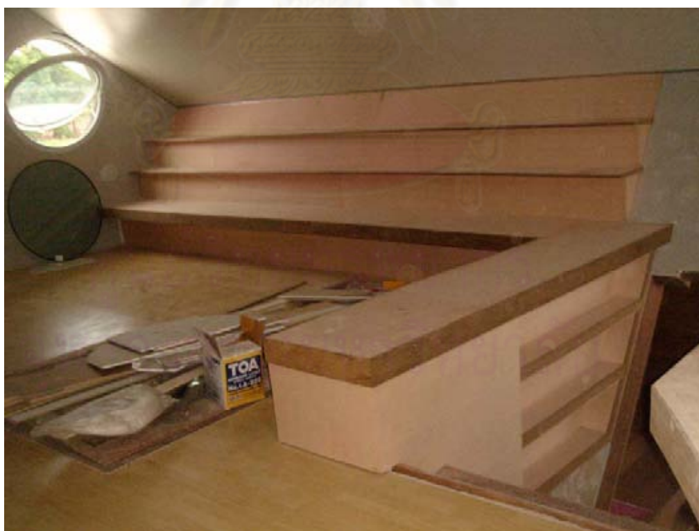
ภาพที่ 4-39 ครุภัณฑ์ติดแบบติดถาวร บริเวณชั้น 2 และข้างบนได
