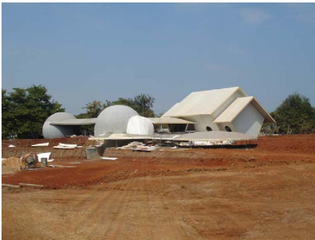
ภาพที่ 4-42 ภาพรวมภายนอกด้านหลังอาคารก่อนแล้วเสร็จ และก่อนปรับปรุงภูมิทัศน์
