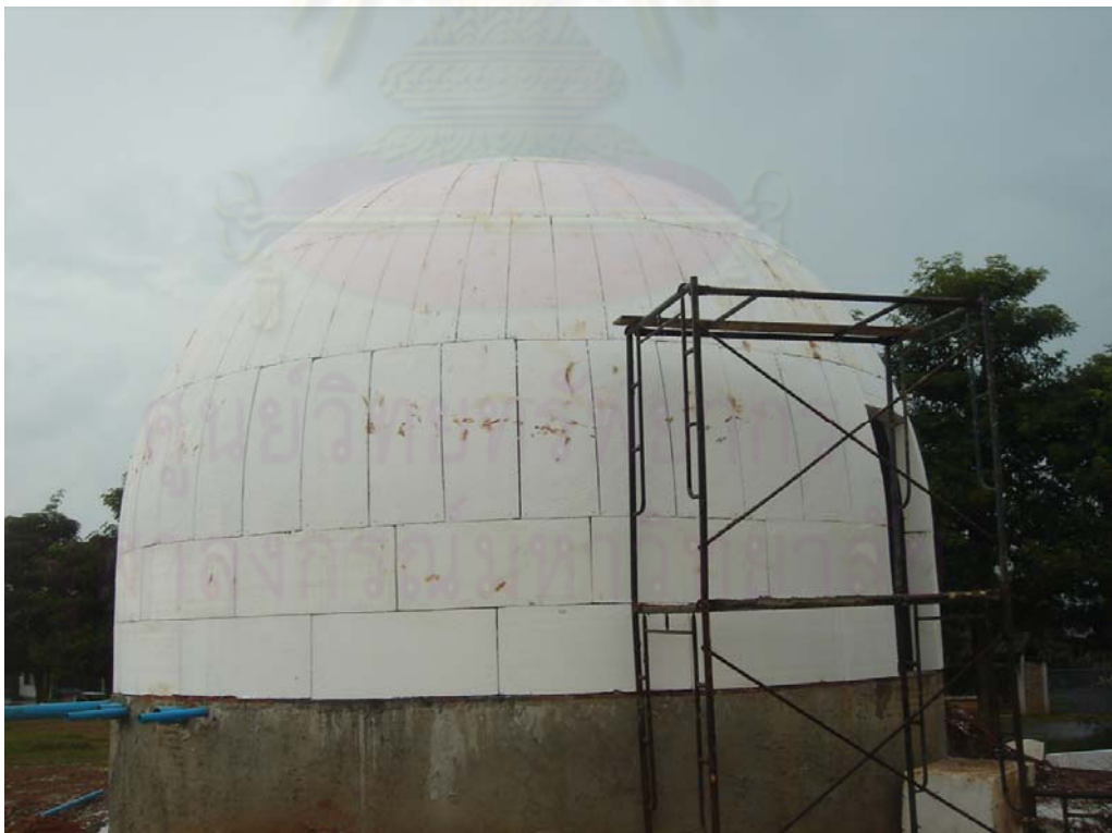
ภาพที่ 4-23 ก่อผนังแล้วเตรียมที่จะวางตาข่ายพลาสติก และฉาบ base coat ในขั้นตอนต่อไป
