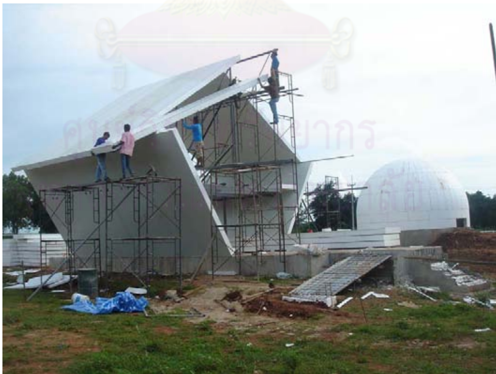
ภาพที่ 4-27 ชั้นหลังคาด้วยวัสดุเดียวกันกับผนัง พาดที่อกไก่เหล็ก และยึดด้วยเหล็กฉาก
