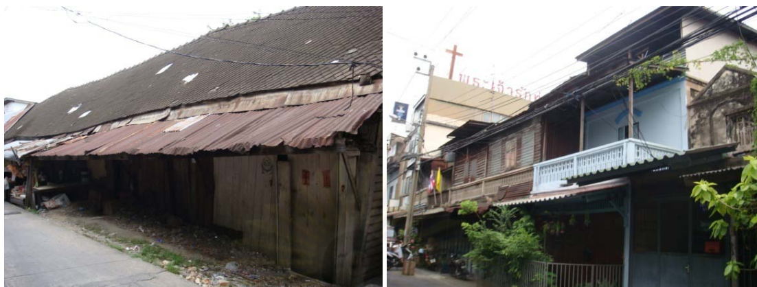
ภาพ 6.4 ลักษณะเรือนแถวไม้เก่าสมัยรัชกาลที่ 5 และอาคารตึกแถวเก่าในสมัยรัชกาลที่ 7 บริเวณริมถนนตลาดพลู(ทางใน) (ที่มา : โดยผู้วิจัย, 2552)
