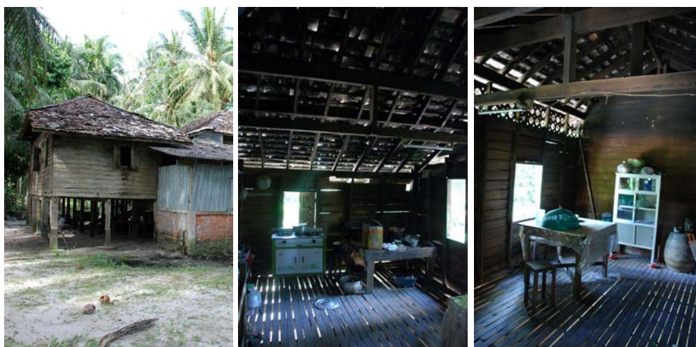
รูปที่ 3-46, 3-47, 3-48 เรือนครัว 6 แม่เสาลังคาทงหล่าทู่ สร้างติดกับเรือนอาศัย โดยมีหลังคาและชานเป็นตัวเชื่อม ใช้ผนังไม้จริงและพื้นไม้เว้นร่อง
