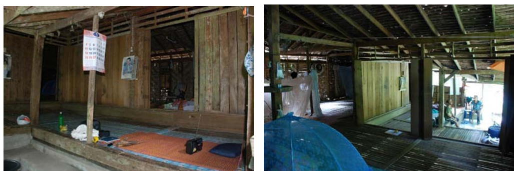
รูปที่ 4-19 แสดงเรือนที่ใช้ประตูบานเพี้ยม 4 ชุดเป็นรูปตัว L ในแต่ละช่วงเสา แต่จะเปิดใช้เฉพาะส่วนที่ต้องการ
