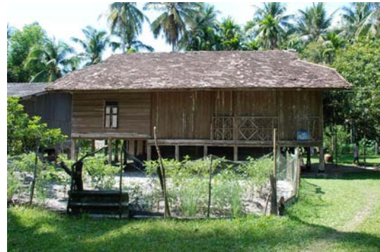
รูปที่ 3-221 ด้านหน้าเรือน นอกชานเรือนและบันไดทางขึ้นเรือนด้านหน้าถูกรื้อออกไปแล้ว
