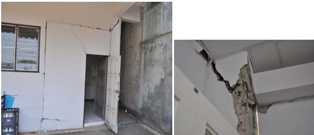
ภาพที่ 1.1 ความเสียหายที่เกิดขึ้นขององค์อาคารในเหตุการณ์แผ่นดินไหวที่พม่า ในปี 2011
