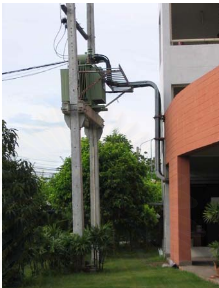
รูปที่ 4.13 แสดงหม้อแปลงไฟฟ้า ซึ่งติดกับอาคารสว่างคนิเวศ
