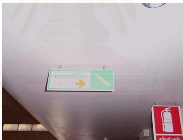
รูปที่ 4.44 แสดงป้ายทางหนีไฟภายในอาคารสรวงคนิเวศ
