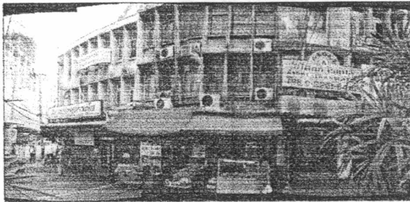
สภาพก่อนการพัฒนา อาคารห้วมุมแยกประตูน้ำเสื่อมสภาพ ขาดการดูแล และใช้ประโยชน์ไม่คุ้มค่า
