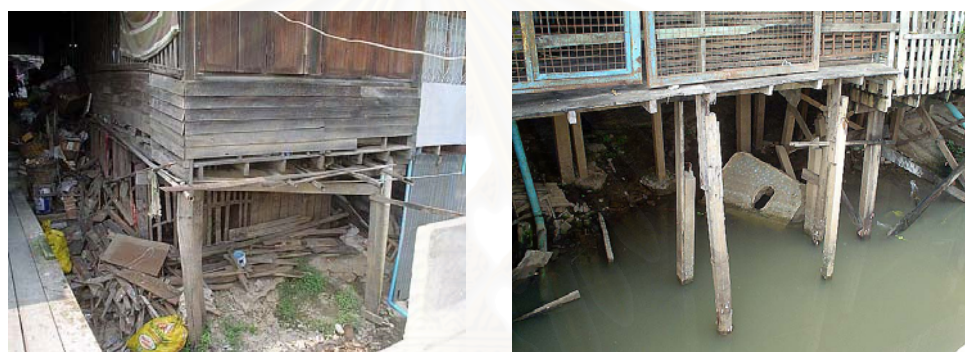
ภาพที่ 4.41 สภาพความทรุดโทรมของโครงสร้างและอาคารในส่วนริมน้ำ (ซ้าย) ภาพที่ 4.42 การพยายามเสริมโครงสร้างในส่วนของพื้นที่ต่อเติมของตัวอาคาร (ขวา) ที่มา : ภาพถ่ายจากการสำรวจในพื้นที่
