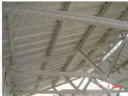
ภาพที่ 105 : ภาพแสดงการติดตั้งวัสดุผนังหลังคาอาคาร
