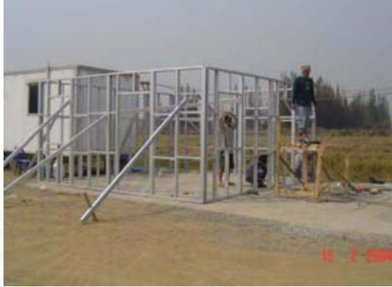
ภาพที่ 102 : ภาพแสดงการค้ำยันชั้นส่วนผนังอาคาร ซึ่งทำให้เกิดการกีดขวางการทำงาน
