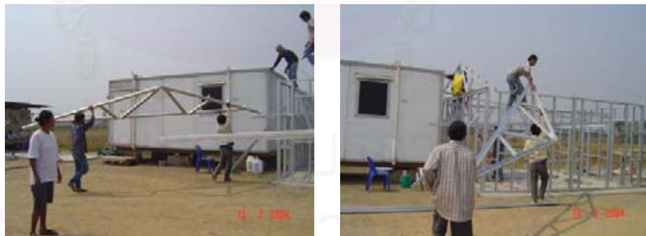
ภาพที่ 103 : ภาพแสดงการยกโครงสร้าง Truss หลังคาขึ้นติดตั้งในอาคารที่ก่อสร้างด้วยวัสดุประเภทเดียวกับอาคารตัวอย่าง
