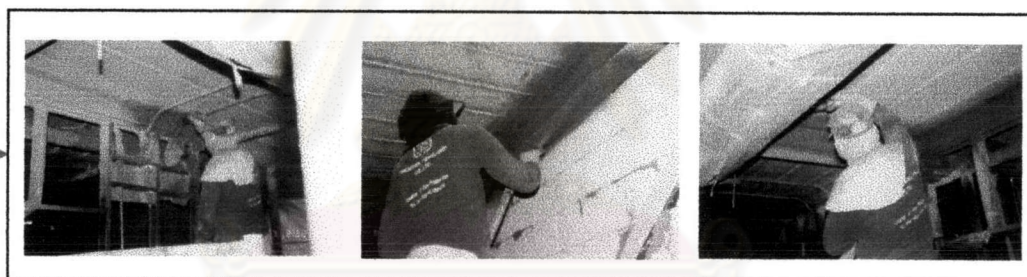
ภาพที่ 5-22 ตัวอย่างการทำงานพ่นสารป้องกันไฟโครงสร้างเหล็ก
