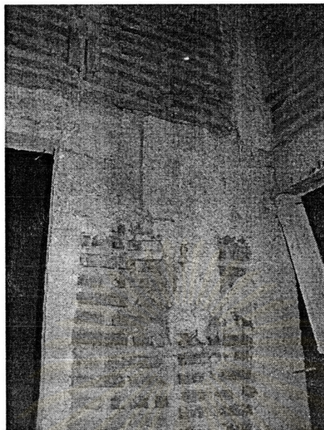
รูปที่ 3.13 แสดงสภาพของคอนกรีตที่ไหลออกจากแบบในการเทหล่อของเสาเอ็นและคานทับหลัง
