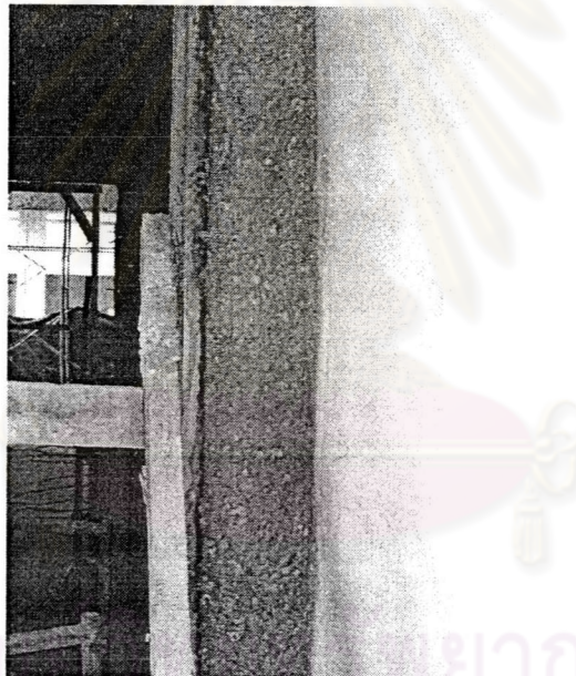
รูปที่ 3.9 ปัญหาของการที่ไม่มีการควบคุมส่วนผสมคอนกรีตส่งผลต่อคุณภาพของคอนกรีตเสาเอ็น
