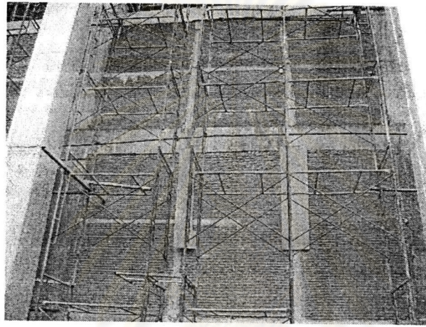
รูปที่ 3.21 แสดงไม้แบบข้างริมนอกของอาคารที่ใช้ในการหล่อเสาเอ็นและคานทับหลัง ค.ส.ล.
