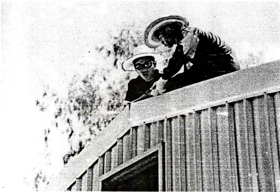
ภาพที่ 5-58 แสดงการติดตั้งครอบจั่วเพื่อให้ประกอบกับสันหลังคาบ้านได้พอดี
