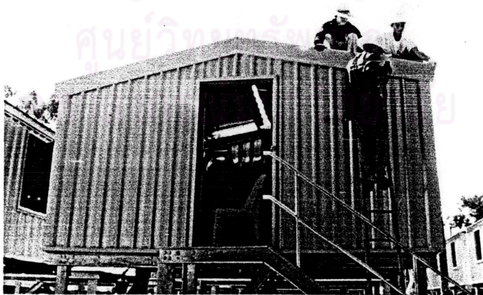
ภาพที่ 5-24 ประกอบกรอบมุมเข้ากับส่วนผนังและหลังคาทั้ง 2 ด้าน
