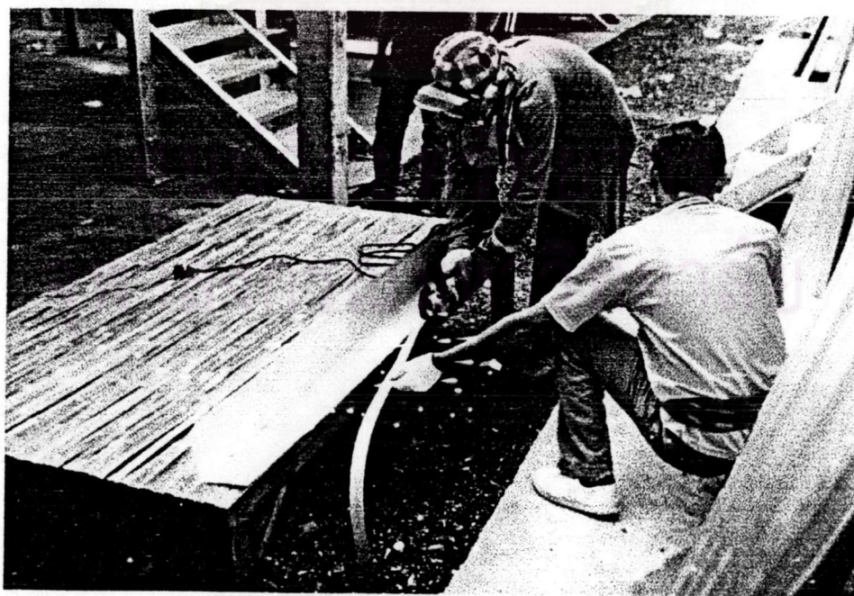
ภาพที่ 5-51 แสดงส่วนแผ่นครอบข้างที่จะต้องตัดทิ้งบางส่วน เพื่อให้ปิดมุมผนังได้พอดี
