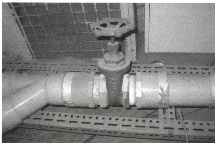
รูปที่ 4.7 วาล์วปรับอัตราการไหลอากาศ
