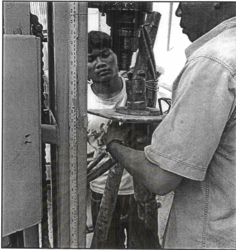
รูปที่ ข.3 การติดตั้งหัวฉีดเข้ากับอุปกรณ์ส่วน Base Machine
