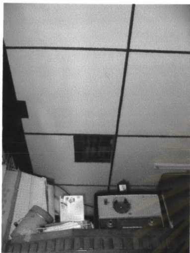
( ภาพที่ 3.12 ) ความเสียหายส่วนฝ้าเพดาน บ้านป่าเกี๊ยะ แซ่เอี้ยว จากกิ่งยางนาร่วงใส่หลังคา
