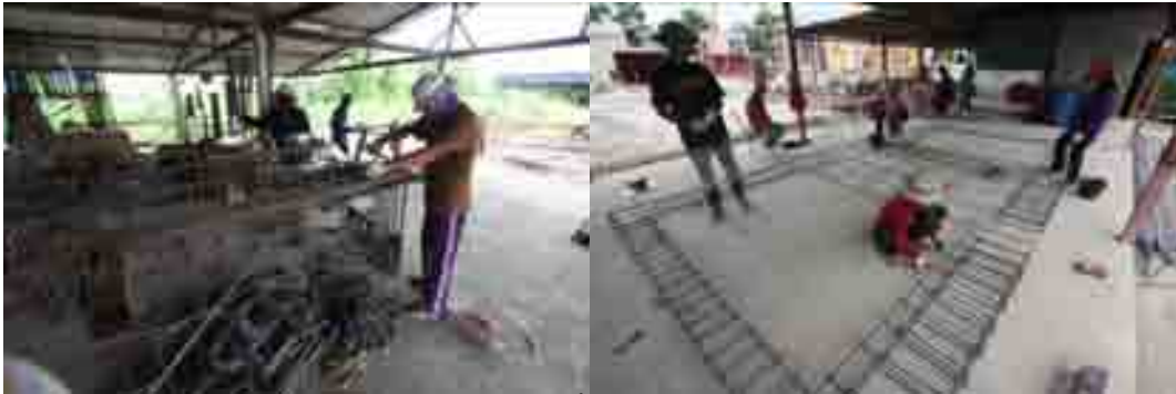
ภาพที่ 5-3 โรงตัดและลานขึ้นรูปงานเหล็กเสริมคอนกรีต
