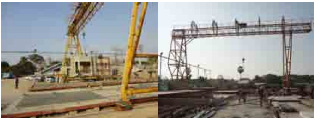
ภาพที่ 5-81 การขนส่งขึ้นส่วนด้วยเครนภายในโรงงานผลิตขึ้นส่วนคอนกรีตสำเร็จรูป
