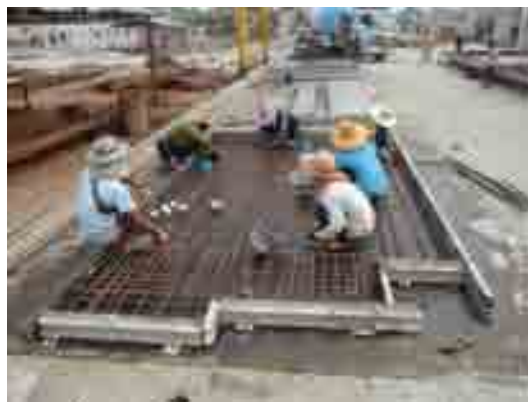
ภาพที่ 5-67 การติดตั้งงานเหล็กเสริมในชั้นส่วนผนังคอนกรีตสำเร็จรูป
