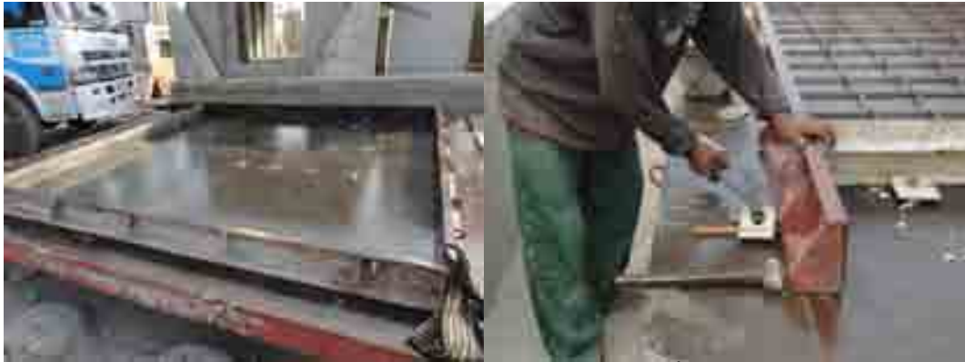
ภาพที่ 5-69 การเตรียมแบบหล่อผนังและการยึดแบบข้างขึ้นส่วนผนังสำเร็จรูป
