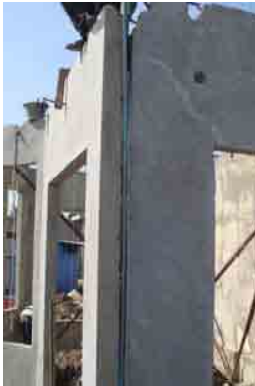
ภาพที่ 5-40 งานเทคอนกรีตเชื่อมรอยต่อ(joint)ผนัง
