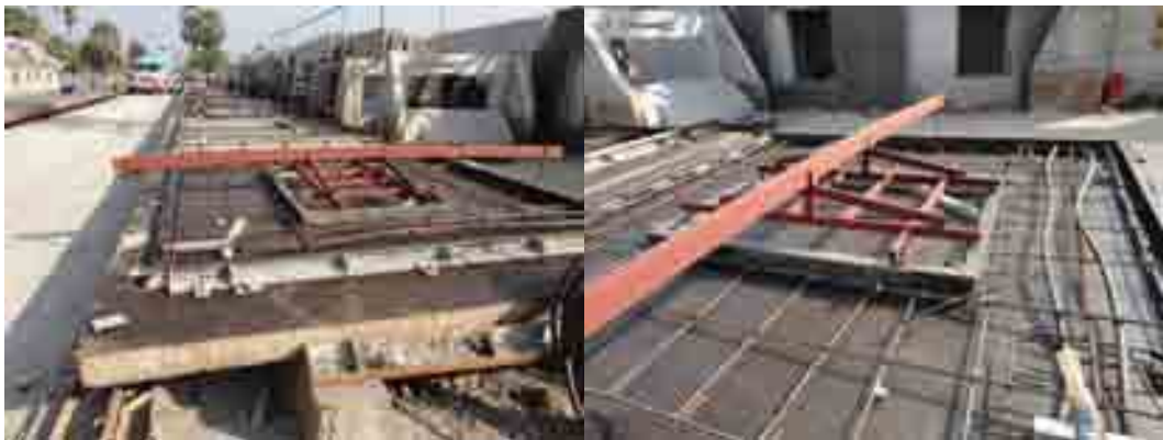
ภาพที่ 5-73 แบบที่ผ่านการตรวจและพร้อมที่จะเทคอนกรีตต่อไป
