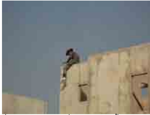
ภาพที่ 5-51 เทคอนกรีตเชื่อมปิดรอยต่อขึ้นส่วนผนังชั้น 2
