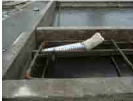
ภาพที่ 5-66 การทำรูสำหรับสอดเหล็ก Tie bar สำหรับติดตั้งชั้นส่วนที่ฝังในแบบหล่อ
