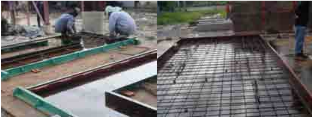
ภาพที่ 5-13 การติดตั้งงานเหล็กเสริมในชั้นส่วนผนังคอนกรีตสำเร็จรูป
