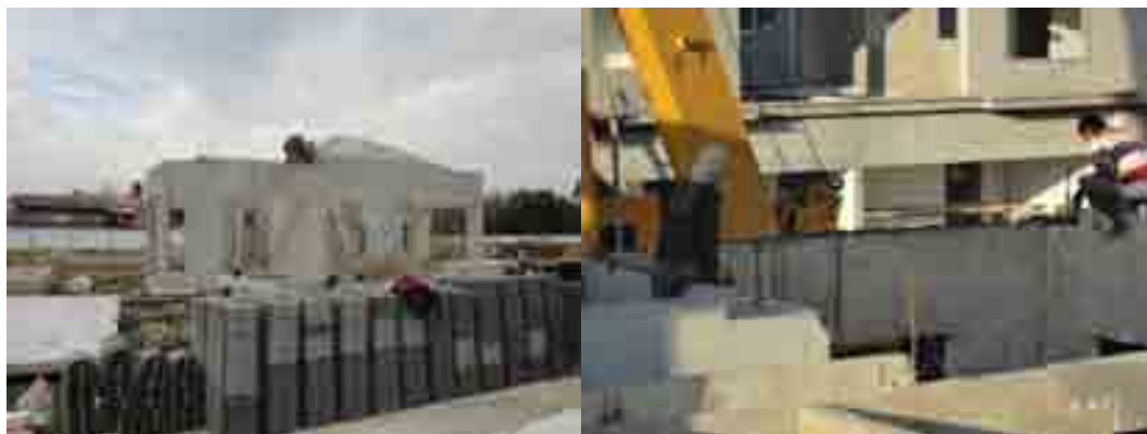
ภาพที่ 5-102 งานเตรียมพื้นที่ก่อนติดตั้งพื้นชั้น 2
