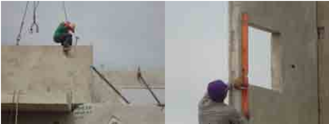
ภาพที่ 5-49 ตรวจสอบระดับการติดตั้งผนังชั้น 2
