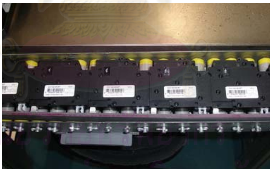
รูปที่ 4.20 ลักษณะเบรกเกอร์ที่อยู่บนรางลำเลียง หลังการปรับปรุง
