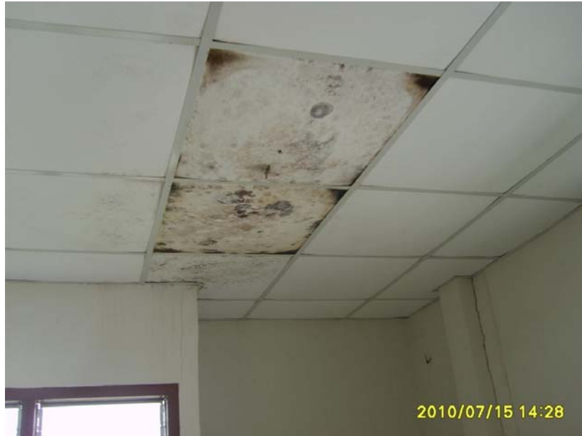
ภาพที่ 5.44 ความเสียหายที่เกิดจากหลังคารั่วซึม
