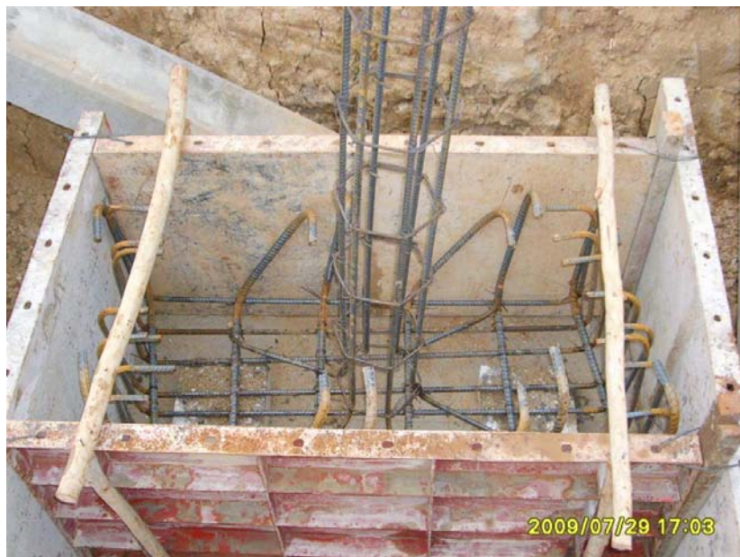
ภาพที่ 5.28 แสดงการเสริมเหล็กฐานรากที่ไม่เรียบร้อย
