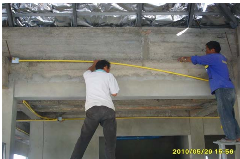
ภาพที่ 5.60 แสดงการทำงานเดินสายไฟภายในอาคาร
