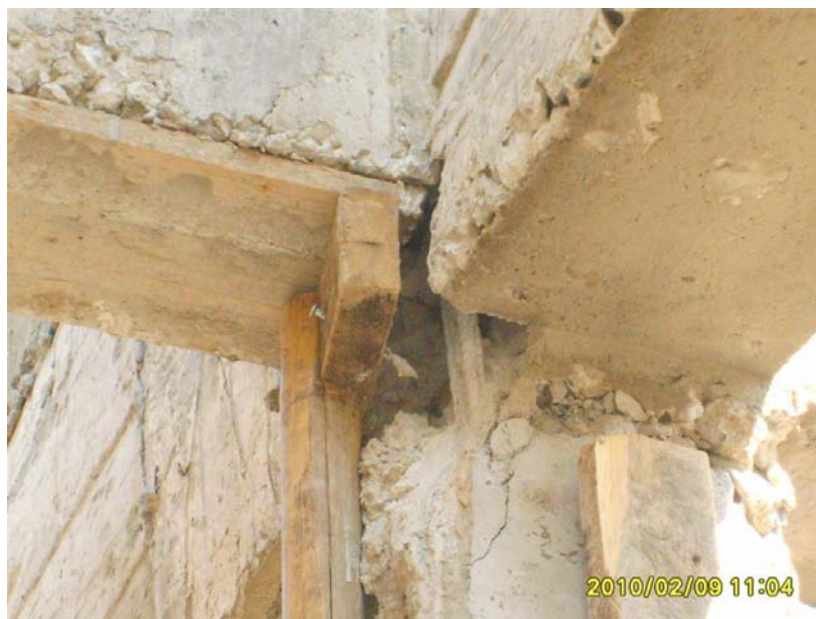
ภาพที่ 5.33 แสดงปัญหาการเทคอนกรีตไม่เต็มแบบเกิดโพรงในตัวโครงสร้าง
