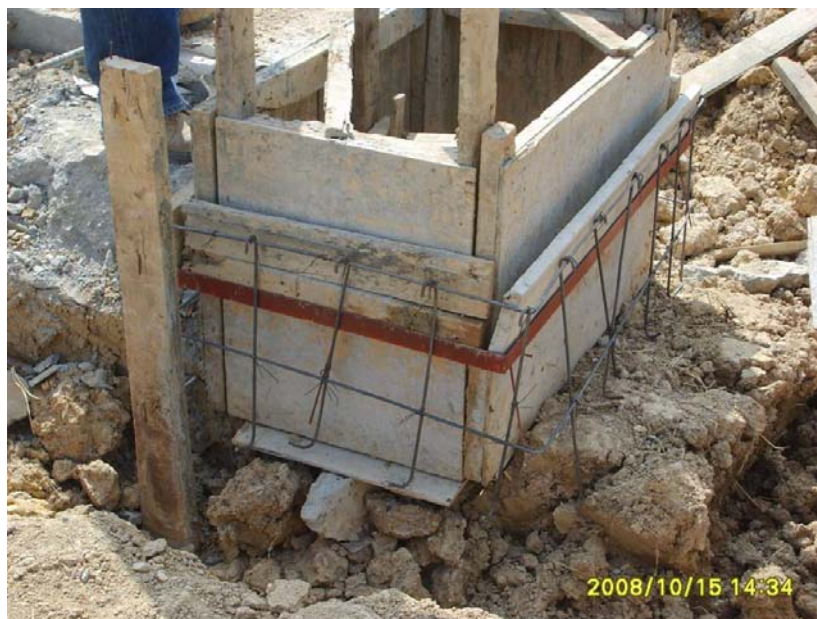
ภาพที่ 5.12 แสดงการต่อปากบ่อพักที่ไม่ถูกต้อง
