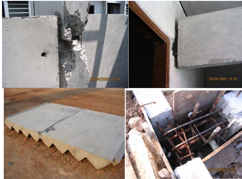
ภาพที่ 5.39 แสดงปัญหาต่างๆที่พบบ่อยในการทำงานระบบขึ้นส่วนสำเร็จรูป
