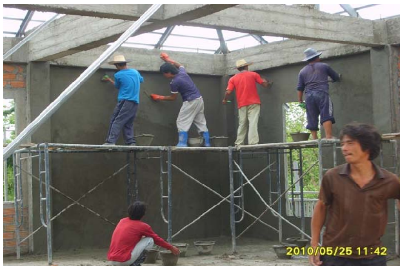
ภาพที่ 5.50 แสดงการทำงานฉาบปูนผนังก่ออิฐ
