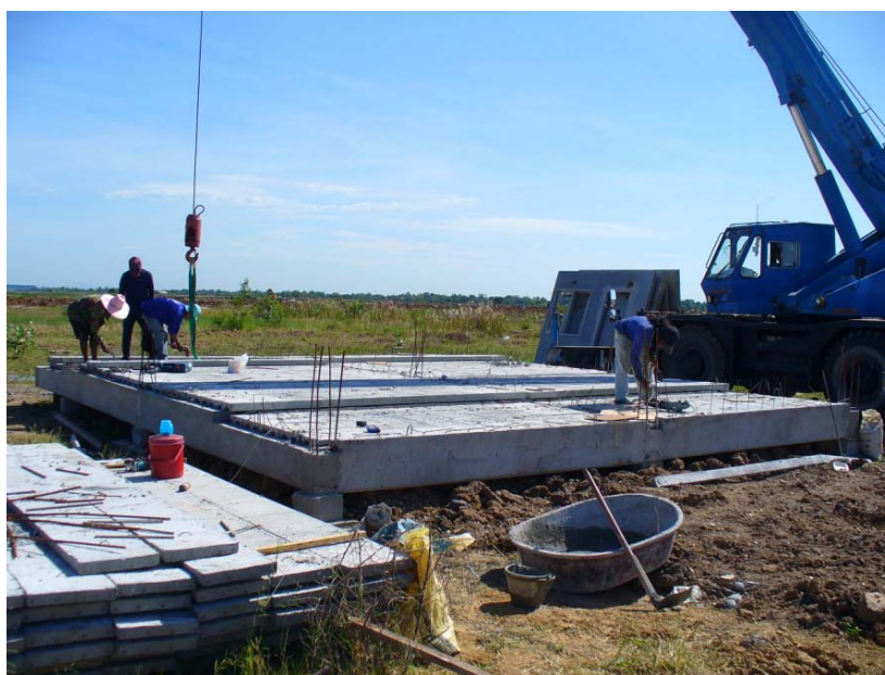
ภาพที่ 5.36 แสดงการติดตั้งระบบพื้นสำเร็จรูป
