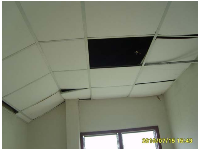
ภาพที่ 5.48 ฝ้าเพดานที่หลุดร่วงเสียหาย
