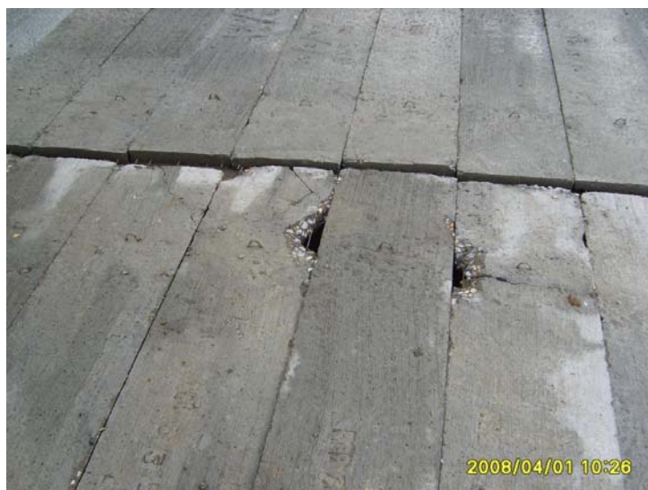
ภาพที่ 5.38 แผ่นพื้นสำเร็จรูปที่เกิดการแตกร้าวเสียหายระหว่างการทำงาน
