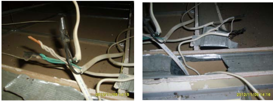
ภาพที่ 5.61 แสดงการต่อสายไฟที่ไม่ถูกต้อง เสี่ยงต่อการเกิดไฟฟ้าลัดวงจร
