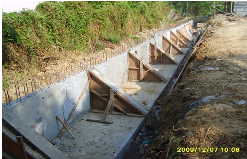
ภาพที่ 5.18 แสดงการทำงานรั้วแบบมีกำแพงกันดิน
