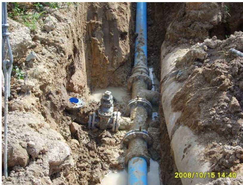
ภาพที่ 5.13 แสดงงานวางท่อระบายน้ำที่เป็นอุปสรรคต่องานวางท่อประปา
