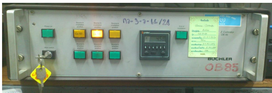
ภาพที่ ง.2 เครื่องควบคุมการฉายรังสี OB85 พร้อมระบบควบคุมเวลา
