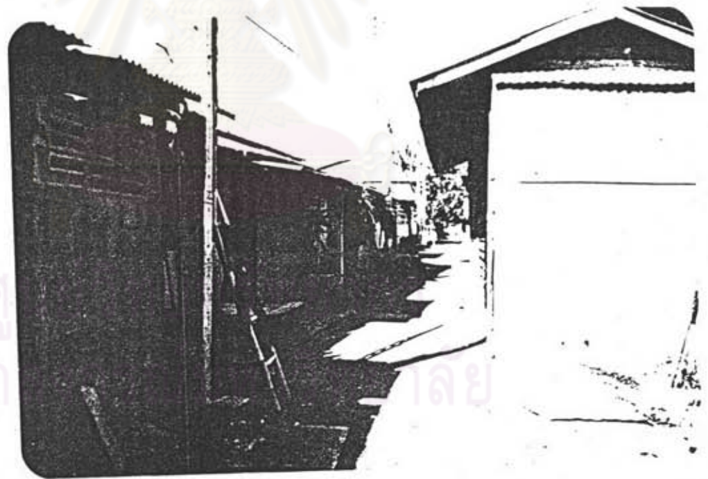
ภาพที่ จ ๑๗ ลักษณะอาคารและสภาพแวดล้อมที่เสื่อมโทรมไม่ถูกสุขลักษณะใน บริเวณของชุมชนชายทะเล และน้ำทิ้งที่เป็นน้ำเสียของชุมชนเหล่านี้ก็จะไหลไป ลงทะเล ก่อให้เกิดมลภาวะในภาพที่เห็นคือ ซอยกร เกรียงมุด
