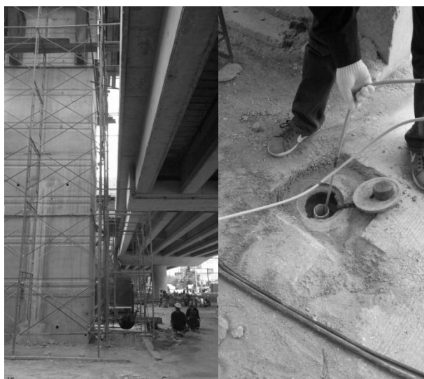
ภาพที่ 4.2 ท่อวัด Inclinator ในโครงการรถไฟฟ้าสายสีม่วง
