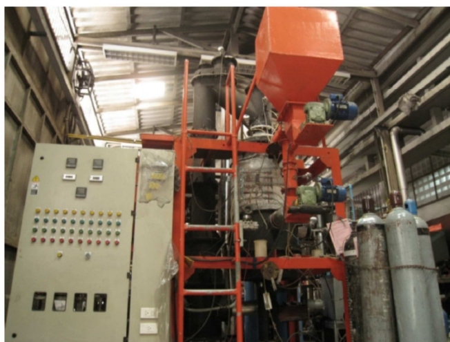
รูปที่ 3.3 เตาผลิตแก๊สแบบเบดคู่และส่วนประกอบต่างๆของเครื่อง (Dual-bed gasifier and other equipments)
