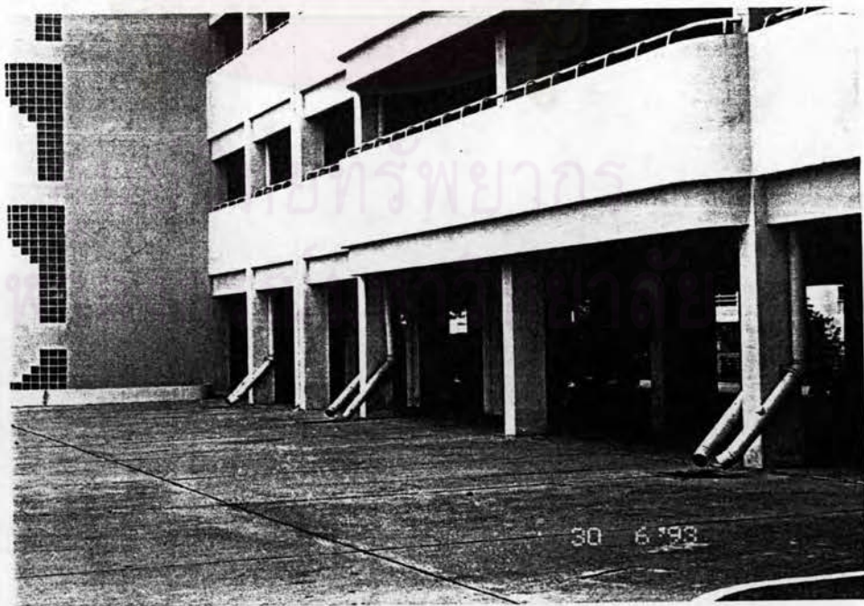
ภาพที่ 4.87 บริเวณใต้ถุนชั้นล่างของอาคาร ใช้สำหรับเป็นที่จอดยานพาหนะของผู้พักอาศัย
