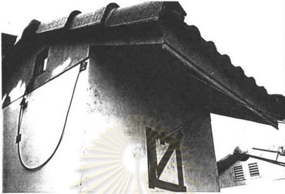
ภาพที่ 3.3.9 : การติดตั้งสายเทอริโมคัมเบิลเข้ายังจุดที่ต้องการวัดอุณหภูมิ หลังจากติดตั้งสายแล้ว จะใช้โฟมหนา 4 นิ้วปิดช่องเปิดที่เปิดสำหรับสายวัด แล้วฉนวนด้วยเทปผ้า ไมให้มีรูอากาศรั่ว
