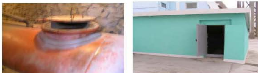
รูปที่ ข.7 Cooling water collection tank and its building
