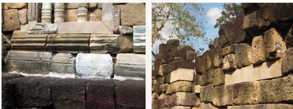
รูป 5-9 และ 5-10 ตัวอย่างการบูรณะในอดีตที่รอการปรับแก้ไขที่โคปุระตะวันออกชั้นนอก
