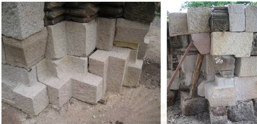
รูป 4-51 และ 4-52 การปรากฏว่าหินใหม่ที่ใช้เป็นก้อนที่มีขนาดเล็กไปต้องแก้ไขก่อน และการสกัดปาหินด้านล่างก้อนที่แสดงถึงความผิดพลาด
