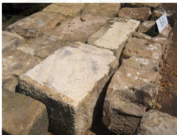
รูป 4-42 ในการทดลองประกอบหินจะต้องไม่มีการสกัดหินเดิมอย่างกรณีที่เห็นในภาพ ได้พบเมื่อมีคำสั่งให้คลี่หินที่ทดลองประกอบ แล้วลงมาเพื่อทำ shop drawing การสกัดหินจะเป็นการปิดทางที่หินก้อนนั้นๆจะกลับไปสู่ที่ตั้งเดิมได้ ส่วนที่ไม่สามารถหาหินเดิมได้ให้สั่งตัดหินใหม่ตามแบบเท่านั้น
