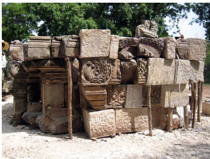
รูป 3-75 และ 3-76 การทดลองเรียงหินตาม shop drawing ด้านล่างก่อนนำกลับคืนสู่ที่ตั้งดั้งเดิม
