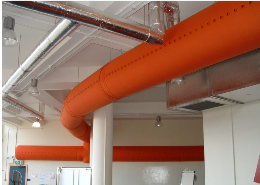
ภาพที่ 5.14 ท่อส่งความเย็น (air sock) ในตัวอาคาร
