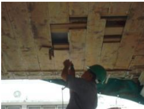
ภาพที่ 6.30 การแสดงความเสียหายของฝ้า เพดานไม้
