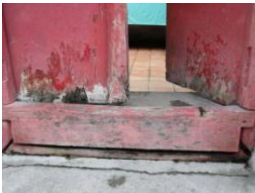
ภาพที่ 7.1 การแสดงบานประตูและวงกบไม้ ผุเสียหายเล็กน้อย บานประตูอยู่ในตำแหน่ง ผนังริมนอกอาคารมีความชื้นสูง
