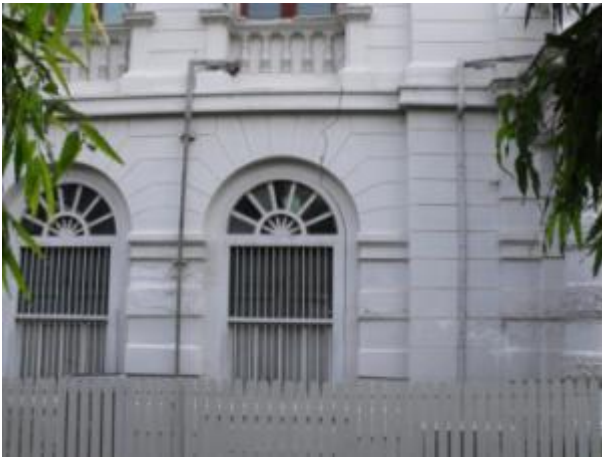
ภาพที่ 3.2 แสดงรอยแตกกร้าวของผนังรับแรงอาคารวิภาคภูวดล ส่วนชั้นล่าง
