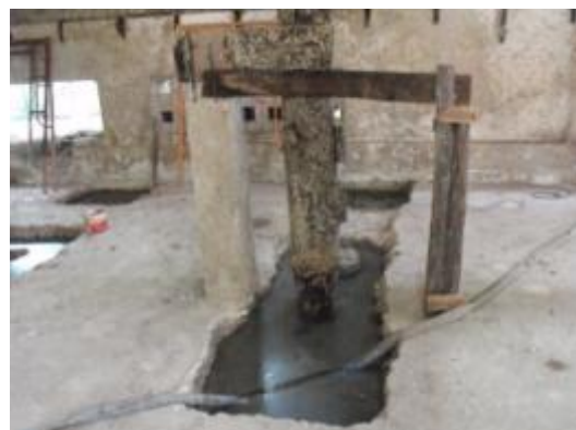
ภาพที่ ข.10 การแสดงค้ำยันเสาไม้ที่ผุขาดก่อนบูรณะอาคาร
