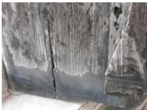
ภาพที่ 7.9 การแสดงผิวไม้เดิมเสียหายไม้แตกเป็นร่องตำแหน่งตาไม้ บานประตูด้านล่างผู้มีการปื้อซ่อมผิวไม้จากการบูรณะในครั้งก่อน
