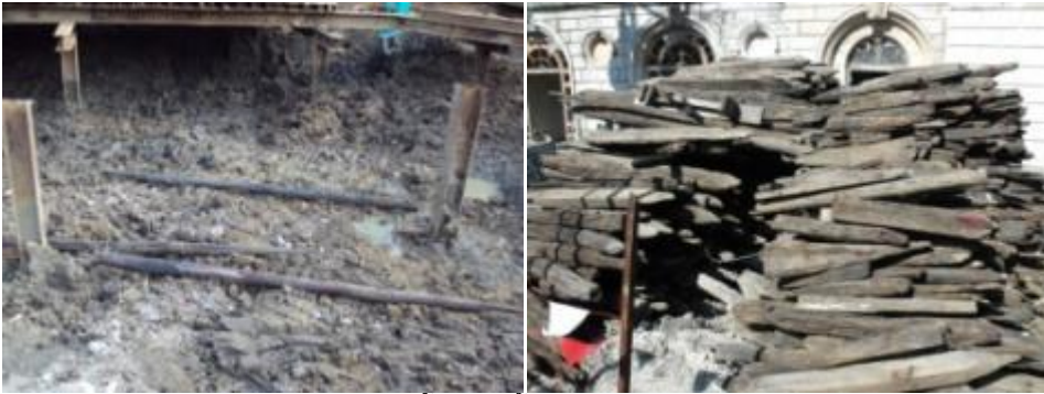
ภาพที่ 3.15 การแสดงเสาเข็มไม้ที่รื้อถอนขึ้นจากฐานรากเดิม เเข็มไม้บางส่วนผุเสียหาย และมีขนาดความยาวเสาเข็มที่ไม่เท่ากัน
