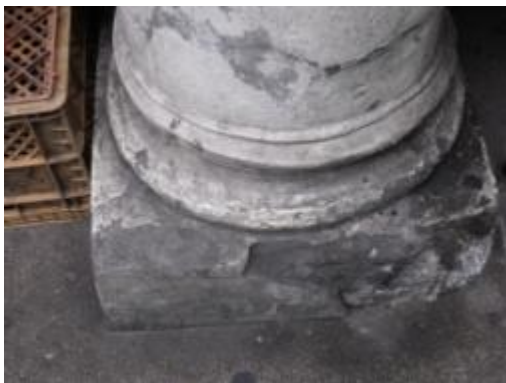
ภาพที่ 4.68 การแสดงปูนฉาบตกแต่งฐานเสาแตกเสียหาย
