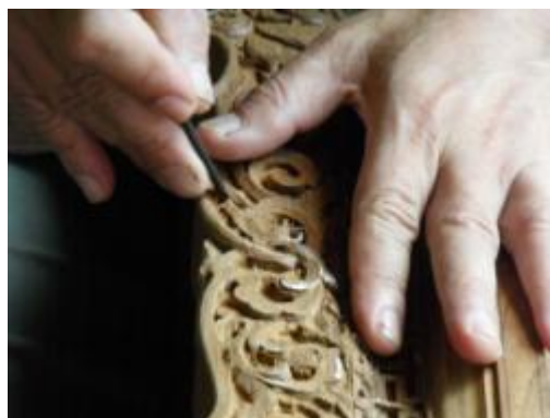
ภาพที่ ฉ.29 การแสดงแกะสลักไม้เพื่อใช้ บูรณะทดแทนไม้เดิมที่ผุ
