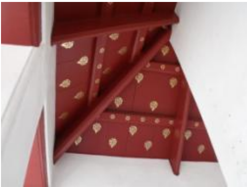
ภาพที่ ๑.103 การแสดงโครงสร้างหลังคา เมื่อบูรณะเสร็จ
