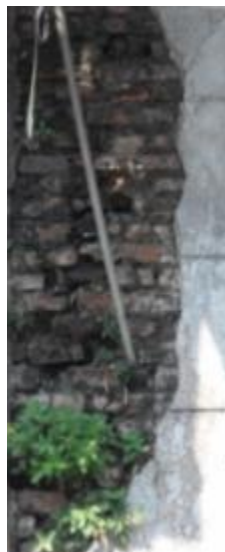
ภาพที่ 4.16 การแสดงความเสียหายของผนังอิฐในแนวตั้งรอยแตกร้าวตามร่องอิฐ
