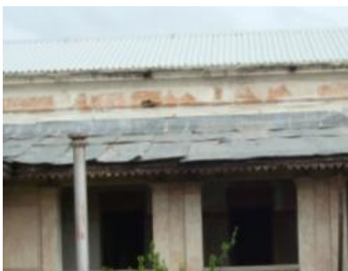
ภาพที่ 6.11 การแสดงโครงหลังคาที่ผุเสียหาย ดำเนินการมุงสังกะสีไว้ชั่วคราว
