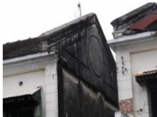
ภาพที่ 4.52 การแสดงเชื้อราดำเจริญเติบโต บนผิวผนังด้านนอกอาคาร
