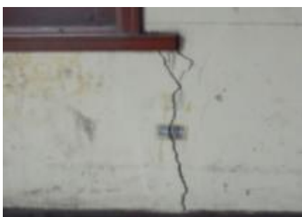
ภาพที่ 2.18 การแสดงติดตั้งกระจกกับผนังที่ โครงสร้างยังมีการทรุดตัว
