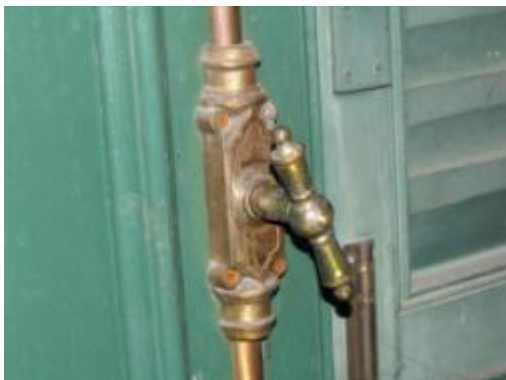
ภาพที่ 7.7 การแสดงอุปกรณ์ประตู่ของ ดั้งเดิมเกลียวภายในเสียหายไม่สามารถใช้ งานได้
