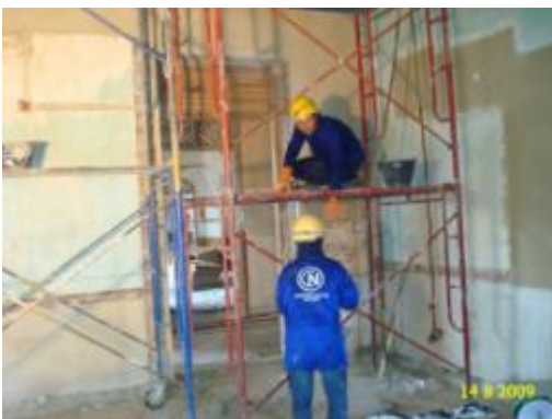
ภาพที่ ง.44 การแสดงฉาบซ่อมผิวผนัง โดย ซ่อมเฉพาะตำแหน่งที่เสียหาย
