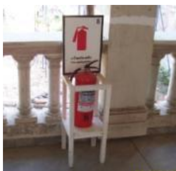
ภาพที่ ข.54 การแสดงจัดเตรียมถังดับเพลิงให้ครอบคลุมพื้นที่ของอาคารโบราณสถาน
