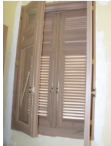
ภาพที่ ช.40 การแสดงซ่อมบูรณะประตูไม้ และติดตั้ง
