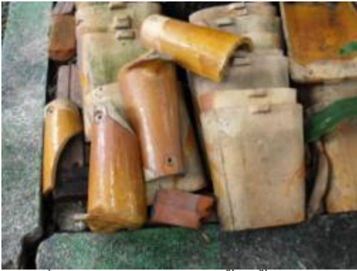
ภาพที่ ๑.7 การแสดงกระเบื้องหรือถอนออก จากหลังคาแตกเสียหายบางส่วน
