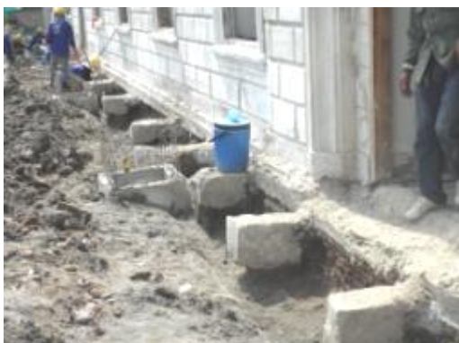
ภาพที่ ค.20 ภาพแสดงคานคอนกรีตเสริมเหล็กวางบนหัวเสาเข็มเหล็กเพื่อรองรับน้ำหนักผนังก่ออิฐรับแรง
