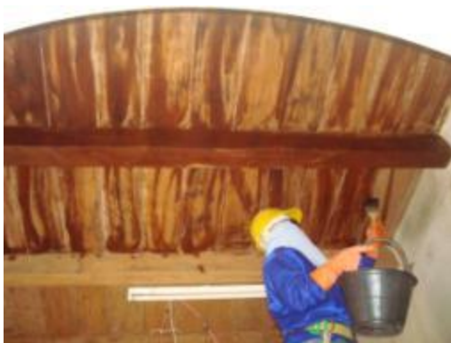
ภาพที่ จ.11 การแสดงการทำงานน้ำยาป้องกัน ปลวกใต้พื้นไม้และโครงสร้างคาน
