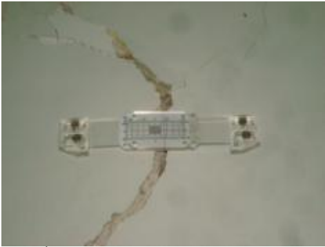
ภาพที่ ค.3 การแสดง Crack gauge ติดตั้งบนกำแพงเพื่อตรวจสอบการขยายตัวของรอยร้าว
