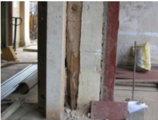
ภาพที่ 4.8 การแสดงเสาไม้ฝังในผนังก่ออิฐ รับแรงมุ ผนังชั้นที่ 1
