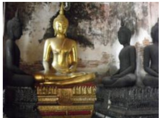
ภาพที่ 4.44 การแสดงการผนังปูนเสื่อมสภาพตำแหน่งที่มีภาพจิตรกรรมฝาผนังและมีราชวและราดำบนผนัง
