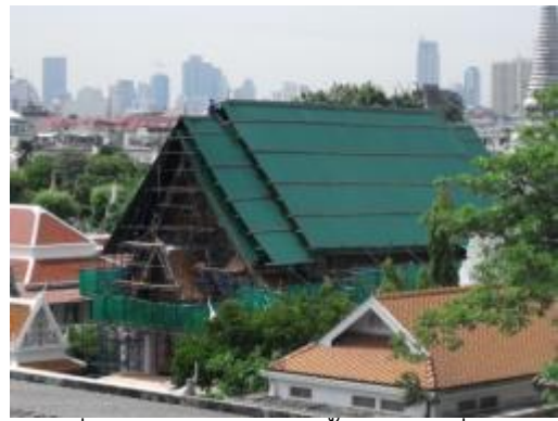
ภาพที่ ๑.5 การแสดงติดตั้งหลังคาชั่วคราว ป้องกันน้ำฝน
