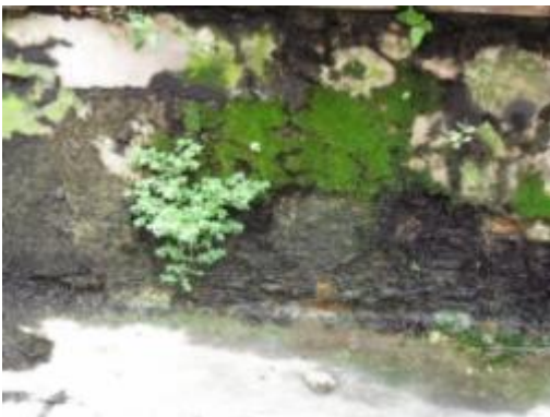
ภาพที่ 4.31 การแสดงผนังก่ออิฐเสียหาย ผิวหน้าเนื่องจากความชื้นและพืชชั้นต่ำ
