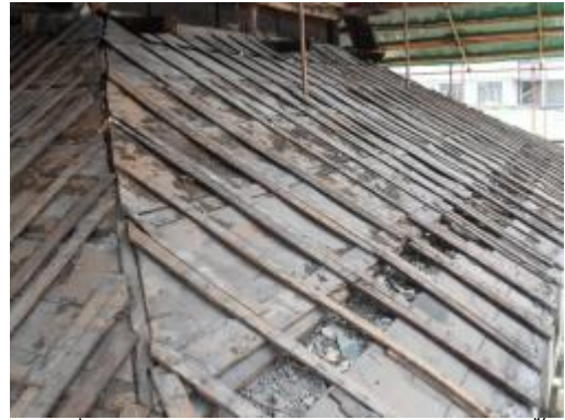
ภาพที่ 6.6 การแสดงโครงหลังคาไม่ได้ติดตั้ง แผ่นกันซึม มีปลวกกัดกินเสียหายบางส่วน
