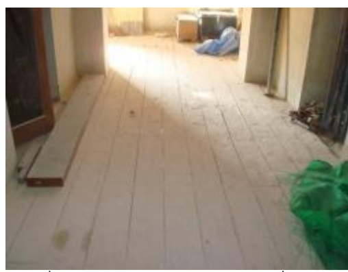
ภาพที่ 5.4 การแสดงความเสียหายที่ผิวไม้เล็กน้อย เนื่องจากการใช้งานและร่องระหว่างแผ่นไม้หดตัว
