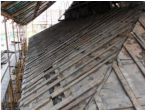
ภาพที่ ๑.44 การแสดงไม้โครงหลังคาและ ปลวกกัดกิน
