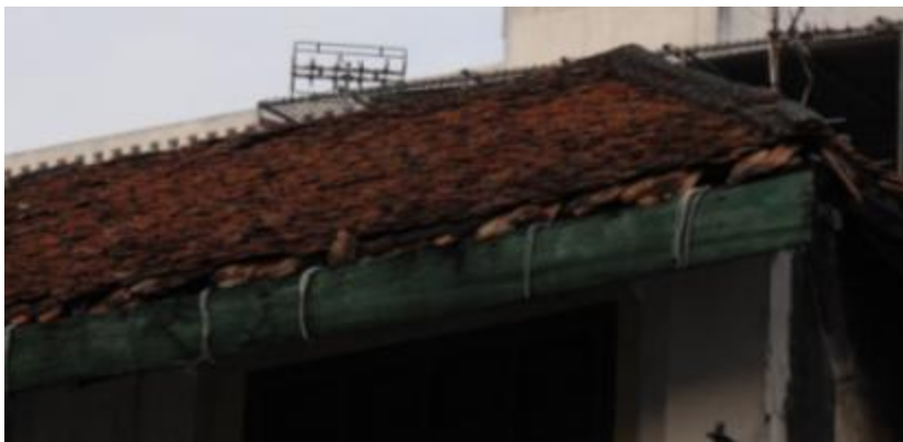
ภาพที่ 5.29 การแสดงหลังคาที่เสียหายมาก น้ำรั่วจากหลังคาลงสู่พื้นไม้ทำให้เกิดความเสียหาย อย่างรุนแรง
