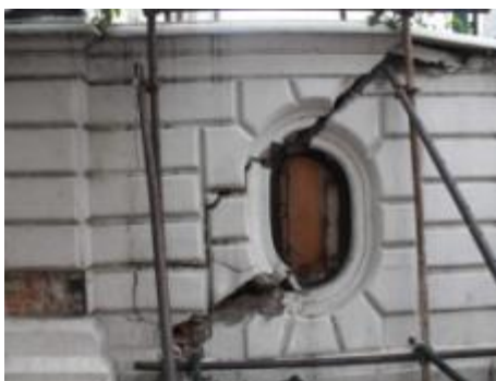
ภาพที่ ข.12 การแสดงค้ำยันกันแพ่งที่เสียหายเนื่องจากการทรุดตัวของฐานราก
