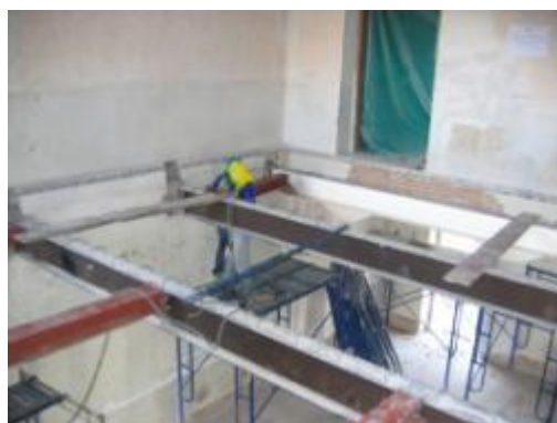
ภาพที่ จ.38 การแสดงติดตั้งคานเหล็กรูปพรรณ
