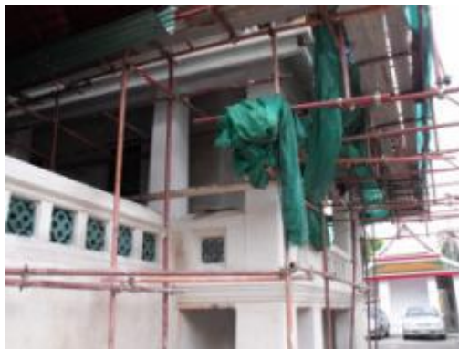
ภาพที่ ๑.๙๙ การแสดงหลังคาภายหลังการเปลี่ยนไม้จันทัน คานอะเสและติดตั้งแปไม้เสร็จ
