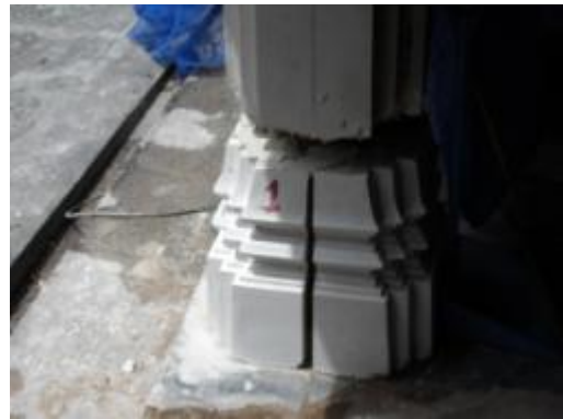
ภาพที่ ง.125 การแสดงติดตั้งฐานเสาปูนปั้น ชนิดหล่อสำเร็จแล้วติดตั้งยึดแน่นด้วยปูนสอ
