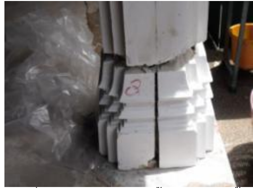
ภาพที่ ง.124 การแสดงติดตั้งฐานเสาปูนปั้น แบบหล่อสำเร็จแล้วติดตั้งยึดแน่นด้วยปูนสอ
