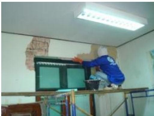
ภาพที่ ค.10 การแสดงอุดรอยร้าวด้วย Cement non shrink grout และเจาะยึดด้วยเหล็กเสริม ภาพตัว U แล้วฉาบปูนส่วนผสมปูนหมัก
