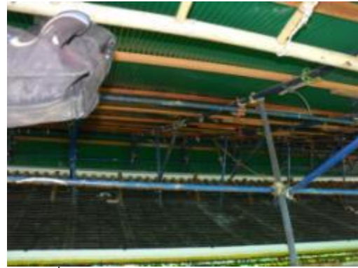
ภาพที่ ข.18 การแสดงรายละเอียดการยึดโครงสร้างชั่วคราวป้องกันฝนบนหลังคา
