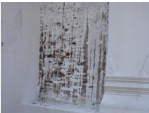
ภาพที่ ง.51 การแสดงราดน้ำปูนบนผนังก่อ อิฐที่แตกกร่อนมาก
