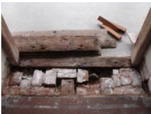
ภาพที่ ๑.14 การแสดงความเสียหายของไม้กระดานพื้นตำแหน่งเหนือผนังก่ออิฐรับแรง
