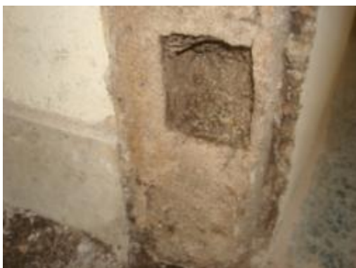
ภาพที่ 7.29 การแสดงปลวกกัดกินวงกบไม้สูญหายไปเกือบทั้งหมดไม่สามารถบูรณะซ่อมแซมไม้เดิมได้จะต้องเปลี่ยนใหม่
