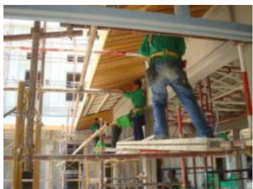
ภาพที่ ฉ.152 การแสดงติดตั้งไม้ฝ้าเพดานใหม่ทดแทนไม้เดิมที่ผุเสียหาย
