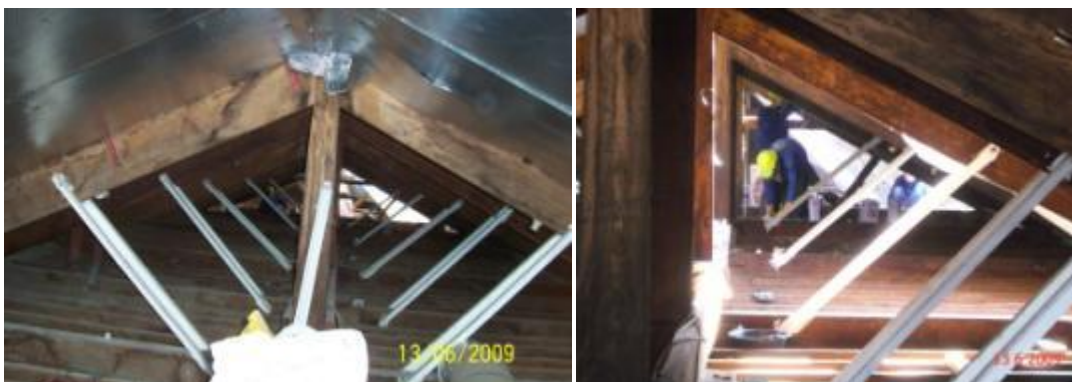
ภาพที่ จ.2 การแสดงเสริมเหล็กรูปพรรณของโครงหลังคาไม้
