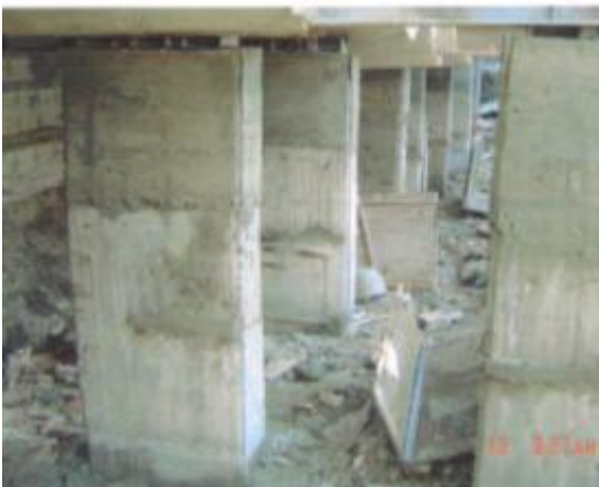
ภาพที่ ค.55 การแสดงต่อม่อภายหลังเทคอนกรีตป้องกันสนิม (ที่มา: บริษัทพีเนสส์ ซอยล์ เทคโนโลยี จำกัด, 2551)
