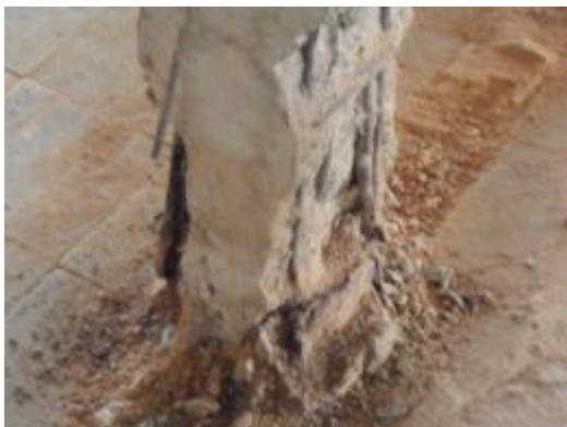
ภาพที่ 2.10 การแสดงลักษณะความเสียหายของโครงสร้างคอนกรีตเสริมเหล็กของอาคารโบราณสถานเหล็กเสริมบริเวณโคนเสาชั้นที่ 1 ผุกร่อน
