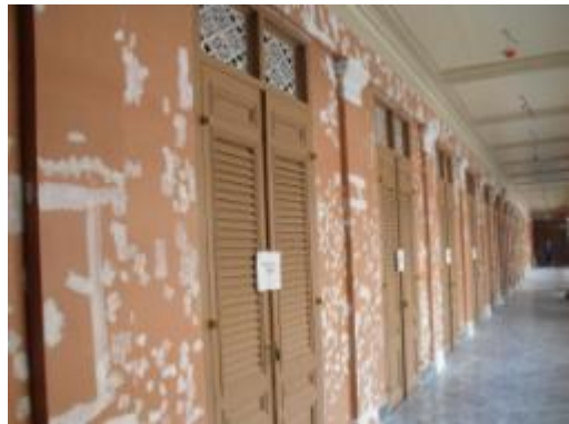
ภาพที่ ง.31 การแสดงโป๊วแต่งรอยร้าวด้วย เคมีภัณฑ์โป๊วแต่งผิวและปกปิดรอยร้าว ภายหลังการทาสีจริง (การแก้ไขงานพื้นผิวไม่ เรียบหรือยังมองเห็นรอยร้าว)
