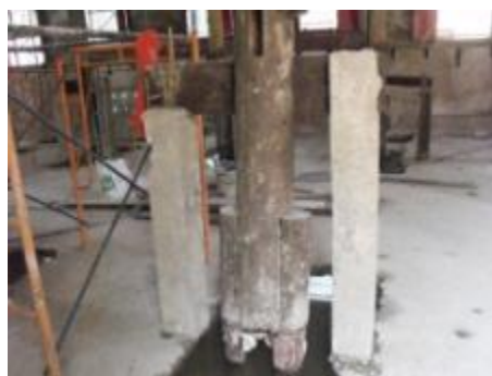
ภาพที่ 3.23 การแสดงโคนเสาไม้ที่ผุเสียหายมากไม่สามารถรับน้ำหนักได้
