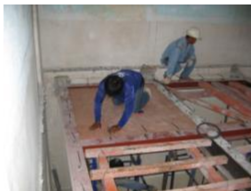
ภาพที่ จ.39 การแสดง การติดตั้งไม้แบบรองรับพื้นคอนกรีต
