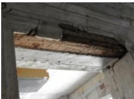
ภาพที่ 4.3 การแสดงคานไม้เหนือช่องเปิดผู้ตำแหน่งผนังชั้นที่ 1
