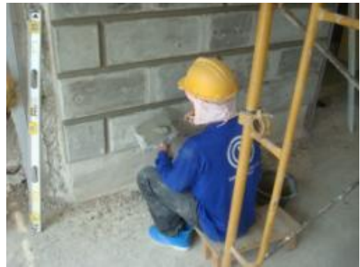
ภาพที่ ง.104 การแสดงแต่งปูนภายหลังจาก ติดตั้งปูนปั้นหล่อสำเร็จรูป
