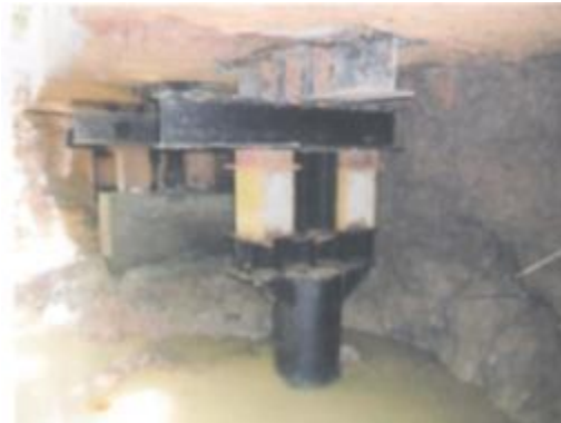
ภาพที่ ค.36 การแสดงติดตั้งคานโครงสร้าง ถ่ายแรงกับเสาเข็มเหล็ก (ที่มา: บริษัทพี เนสต์ ซอยล์ เทคโนโลยี จำกัด, 2554)
