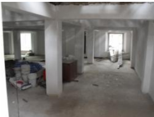
ภาพที่ ค.25 การแสดงลักษณะโครงสร้างอาคารหลังจากบูรณะเสร็จ
