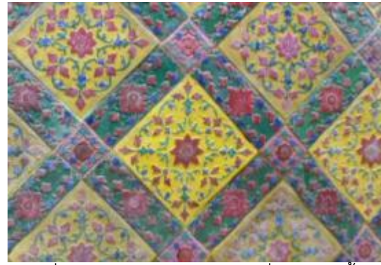
ภาพที่ จ.66 การแสดงซ่อมเปลี่ยนกระเบื้อง เฉพาะตำแหน่งที่เสียหาย
