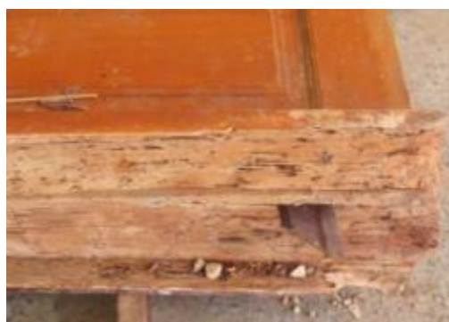
ภาพที่ ข.44 การแสดงลักษณะปลวกกัดกิน วงกบไม้จากด้านในไม่สามารถมองเห็นจาก ด้านนอก ตรวจพบภายหลังจากการรื้อถอน วงกบประตู
