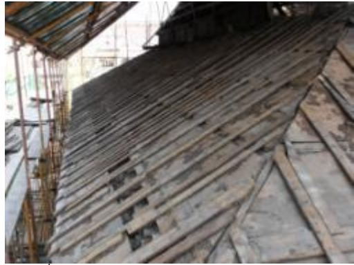
ภาพที่ 6.27 การแสดงฝ้าเพดานไม้พบปลวก กัดกินและผุเสียหายเนื่องจากหลังคารั่ว
