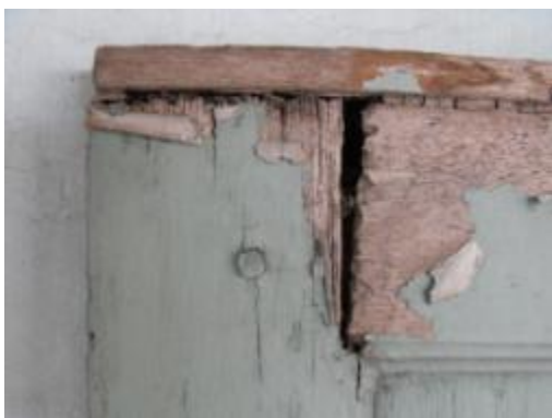
ภาพที่ 7.28 การแสดงบานประตูเนื้อไม้ผุเสียหายมากไม่สามารถซ่อมแซมได้
