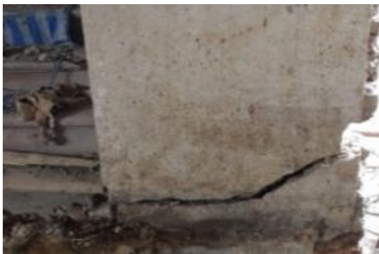
ภาพที่ 3.13 การแสดงรอยร้าวผนังก่ออิฐรับแรงบริเวณผนังชั้นที่ 1
