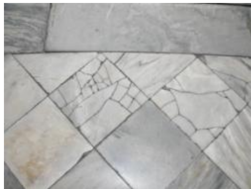
ภาพที่ 5.31 การแสดงพื้นหินอ่อนแตกร้าวเสียหายเฉพาะบางแผ่น
