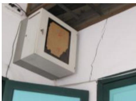
ภาพที่ 3.8 การแสดงลักษณะของรอยร้าวบนผนังแถบกลางอาคาร ชั้นที่ 1
