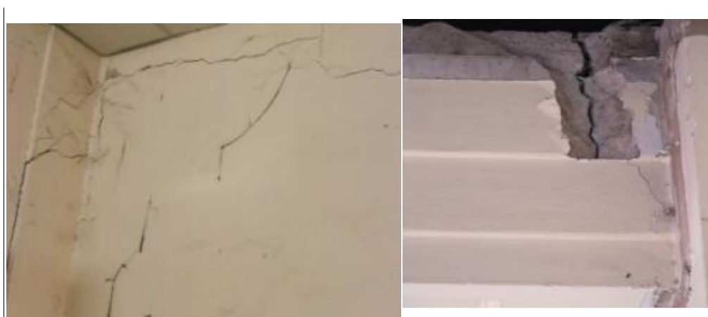
ภาพที่ 3.30 การแสดงผนังก่ออิฐรับแรงและคานชั้น 2 ของอาคารอนุรักษ์แต่กร้าวเนื่องจากการทรุดตัวของอาคาร
