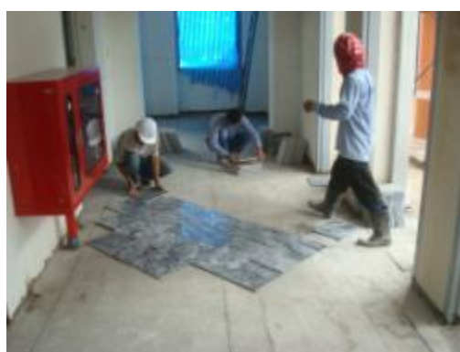
ภาพที่ จ.49 การแสดงจัดเรียงหินเพื่อกำหนดตำแหน่งหินที่เหมาะสมโดยพิจารณาลายหินและสีหินที่กลมกลืนกันก่อนติดตั้งจริง
