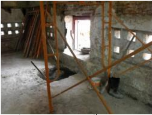
ภาพที่ ค.21 การแสดงสกัดพื้นอาคารเดิม เตรียมทำเสาเข็มเจาะ
