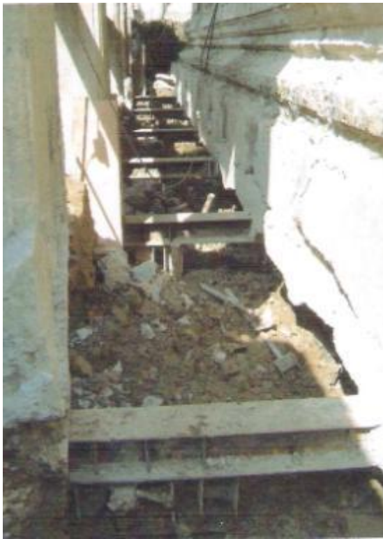
ภาพที่ ค.43 การแสดงติดตั้งคานรับน้ำหนักจากเสาอาคารเพื่อถ่ายแรงลงสู่เสาเข็มเหล็ก (ที่มา: บริษัทพีเนสส์ ซอยล์ เทคโนโลยี จำกัด, 2551)
