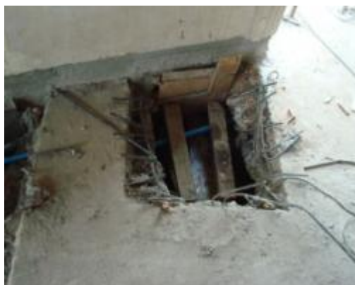
ภาพที่ ค.19 การแสดงเชื่อมติดตั้งคานเหล็กแล้วเสร็จ
