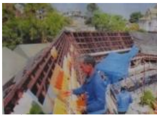
ภาพที่ ฉ.23 การแสดงซ่อมบูรณะหลังคาและติดตั้งกระเบื้องมุงหลังคา
