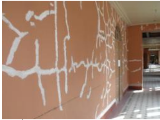
ภาพที่ ง.30 การแสดงโป๊วแต่งรอยร้าวด้วย เคมีภัณฑ์โป๊วแต่งผิวและปกปิดรอยร้าว ภายหลังการทาสีจริง(การแก้ไขงานพื้นผิวไม่ เรียบและยังมองเห็นรอยร้าว)
