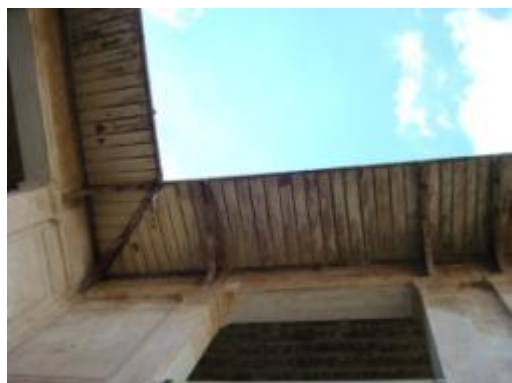
ภาพที่ 6.29 การแสดงฝ้าเพดานไม้ผุเสียหายเนื่องจากความชื้น
