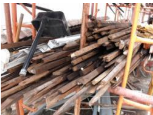
ภาพที่ ฉ.92 การแสดงไม้แประแนงที่รีถอนออกจากโครงหลังคาเนื่องจากผุเสียหาย
