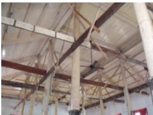
ภาพที่ ๓.๓๙ การแสดงฝ้าเพดานและโครง หลังคา ก่อนการบูรณะ
