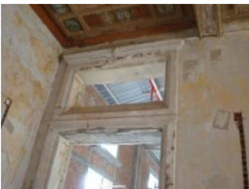
ภาพที่ 4.37 การแสดงลักษณะความเสียหาย ของผนังฉาบปูนผิวหน้าสีกร่อนเล็กน้อย ผนังแตกร้าวเล็กน้อย
