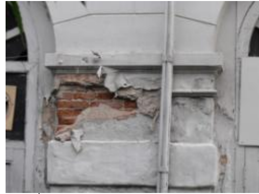
ภาพที่ 4.21 การแสดงความเสียหายของปูนก่อผนังรับแรงตำแหน่งภายนอกอาคาร
