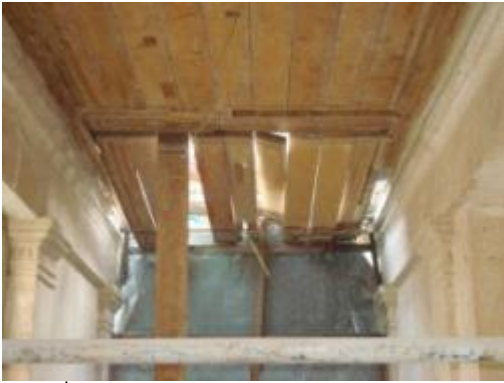
ภาพที่ 6.24 การแสดงความเสียหายของฝ้า เพดานไม้หลุดร่วงจากตำแหน่งเดิม
