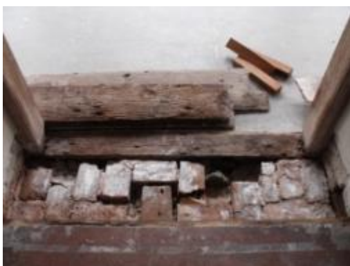
ภาพที่ 5.13 การแสดงความเสียหายของไม้ เนื่องจากวางอยู่เหนือกำแพงก่ออิฐรับแรงที่มีความชื้นสูง
