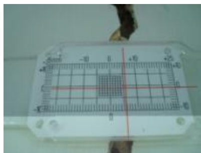
ภาพที่ 2.21 การแสดงภาพถ่าย Crack gauge
