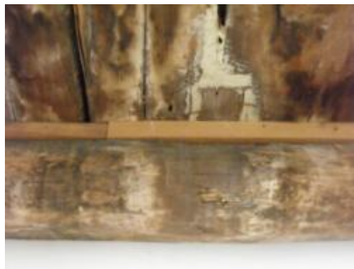
ภาพที่ จ.28 การแสดงวิธีการซ่อมไม้กระดาน พื้นที่เสียหายบางส่วน โครงการบูรณะหอ พระไตรปิฎก วัดเทพธิดารามวรวิหาร
