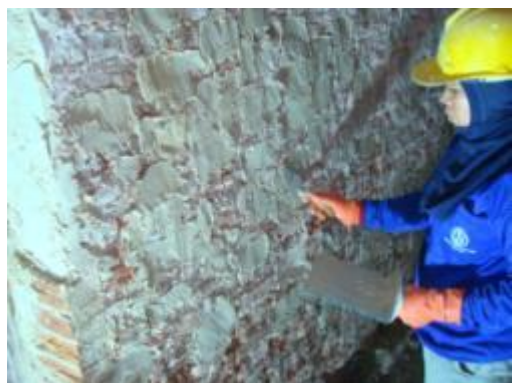
ภาพที่ ง.54 การแสดงอุดซ่อมผนังอิฐโดยใช้ ปูนเป็วอุดตำแหน่งที่อิฐแตกเสียหายและโป้ว ปูนที่ผิวก่อนฉาบให้ขรุขระ
