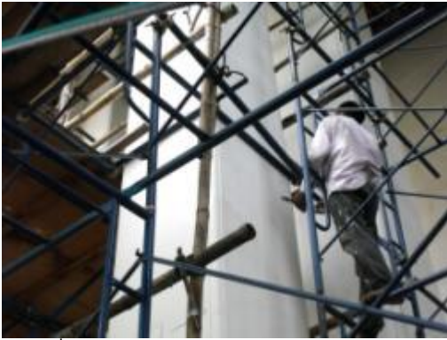
ภาพที่ ง.27 การแสดงโป๊วแต่งรอยร้าวด้วย เคมีภัณฑ์โป๊วแต่งผิวและปกปิดรอยร้าว
