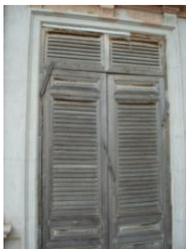
ภาพที่ 7.23 การแสดงความเสียหายของบานหน้าต่างฝวหน้าบานผุเสียหายเนื่องจากความชื้นและไม่เกิดคางขึ้นผุเสียหาย
