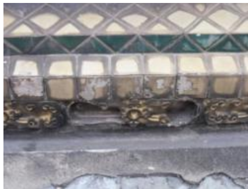
ภาพที่ 5.45 การแสดงกระเบื้องประดับผนัง แตกเสียหายเฉพาะบางแผ่น
