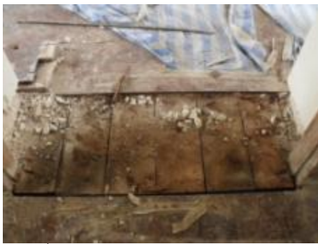
ภาพที่ 5.12 การแสดงความเสียหายของไม้ เนื่องจากวางอยู่เหนือกำแพงก่ออิฐรับแรงที่มีความชื้น
