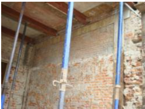
ภาพที่ 4.24 การแสดงผนังก่ออิฐเสียหายเล็กน้อยพอรับสภาพได้
