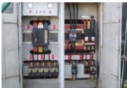
ภาพที่ ข.55 การแสดงใช้อุปกรณ์ไฟฟ้าที่ได้มาตรฐาน มีระบบป้องกันกระแสไฟฟ้าลัดวงจร
