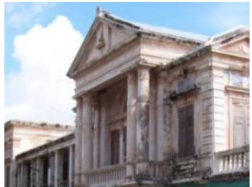
ภาพที่ 4.51 การแสดงเชื้อราดำเจริญเติบโต บนผิวผนังด้านนอกอาคาร
