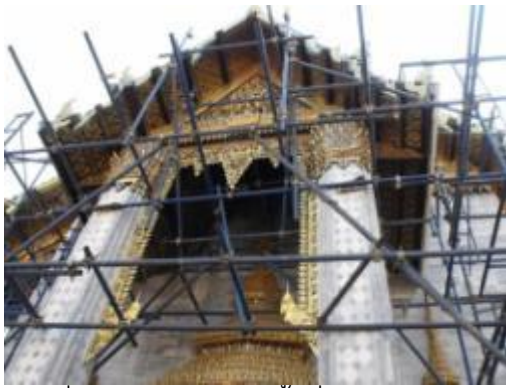
ภาพที่ ๑.3 การแสดงติดตั้งนั่งร้านเตรียมการบูรณะ
