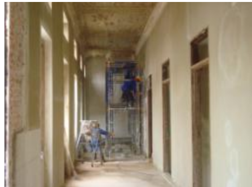
ภาพที่ ง.46 การแสดงฉาบซ่อมผิวผนังเดิมที่ แตกก่อนเสียหาย
