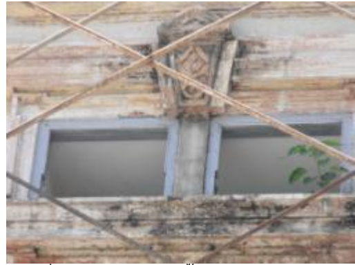
ภาพที่ 4.50 การแสดงเชื้อราดำเจริญเติบโต บนผิวผนังด้านนอกอาคาร
