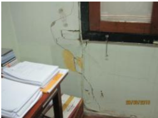
ภาพที่ ค.1 การแสดงภาพการติดตั้ง Crack gauge บนผนังอาคารโบราณสถาน
