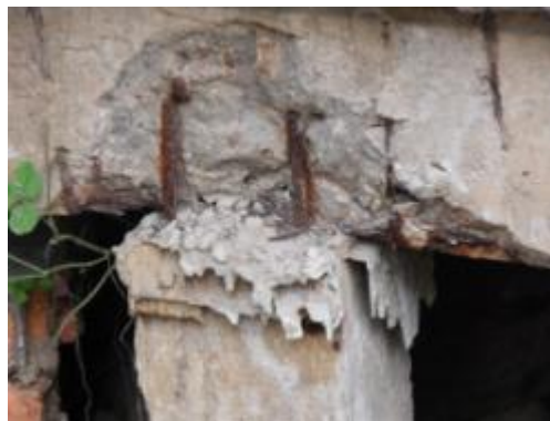
ภาพที่ 2.11 การแสดงลักษณะความเสียหายของโครงสร้างอาคารโบราณสถานเหล็กเสริมบริเวณเสาต่อม่อและคานผุกร่อน
