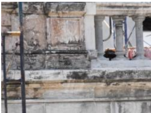
ภาพที่ 4.45 การแสดงเชื้อราดำเจริญเติบโตบนผนังด้านนอกอาคาร
