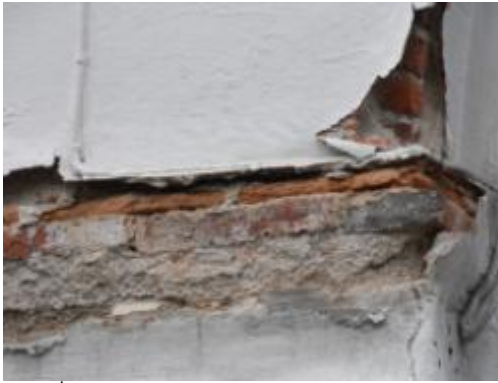
ภาพที่ 4.19 การแสดงความเสียหายของปูนก่อผนังรับแรงตำแหน่งภายนอกอาคาร
