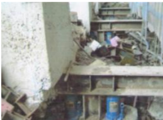
ภาพที่ ค.47 การแสดงลักษณะติดตั้งแม่แรงเตรียมยกอาคาร(ที่มา: บริษัทพีเนสส์ ซอยล์ เทสติ้ง จำกัด, 2551)
