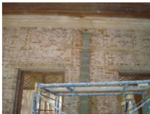
ภาพที่ 3.12 การแสดงตำแหน่งที่เกิดรอยร้าวผนังภายในชั้นที่ 2 และได้ทำการซ่อมรอยร้าวด้วยการใช้เหล็กเจาะยึด
