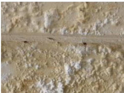
ภาพที่ 4.71 การแสดงความเสียหายของผนัง เนื่องจากเกลือในดินถูกดึงขึ้นสู่ผนังแล้วทำปฏิกิริยาทางเคมีกับสีทาอาคาร
