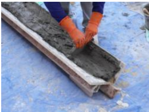
ภาพที่ ง.88 การแสดงใช้แผ่นอะคริลิคตัด เป็นภาพบัวปูนปั้นกดและลากตามแนวแบบ หล่อแล้วกดฝังเหล็กเส้นตามแนวยาวเสริม รับกำลังและป้องกันการแตกร้าว
