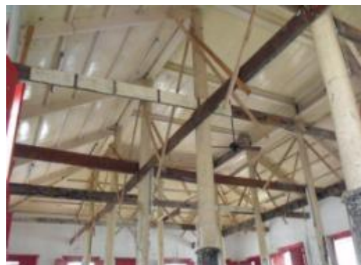
ภาพที่ ข.11 การแสดงยึดโครงสร้างและค้ำยันโครงสร้างป้องกันการโยกตัวของอาคารก่อนบูรณะอาคาร
