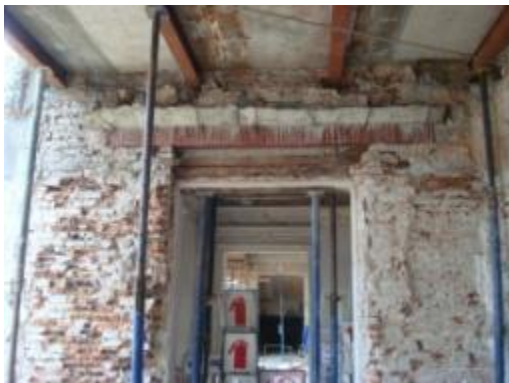
ภาพที่ ง.6 การแสดงใช้เหล็กรูปพรรณเสริมรับแรงทดแทนไม้เดิมที่เสียหาย
