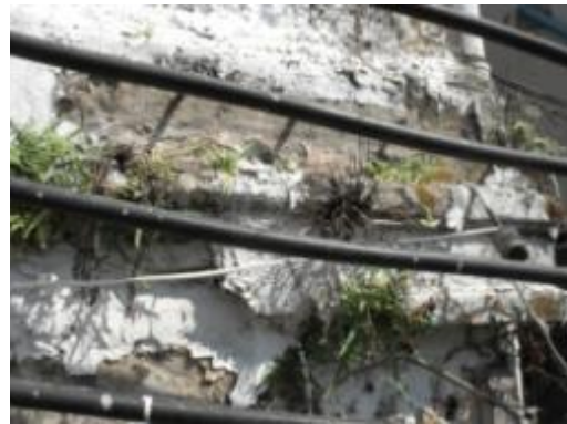
ภาพที่ 4.33 การแสดงผนังก่ออิฐเสียหาย เนื่องจากพืชชั้นต่ำและฝนกรด
