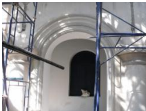
ภาพที่ ง.69 การแสดงผนังอาคารภายหลัง ฉาบปูนบูรณะเสร็จ
