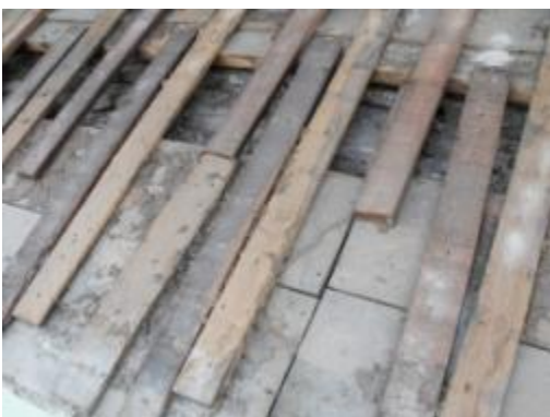
ภาพที่ ๑.45 การแสดงไม้โครงหลังคาและ ปลวกกัดกิน
