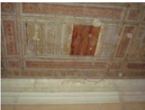
ภาพที่ 6.26 การแสดงไม้ฉลุฝ้าเพดานหลุด หายบางชิ้น ฝ้าเพดานสีลอกพองหมดอายุ
