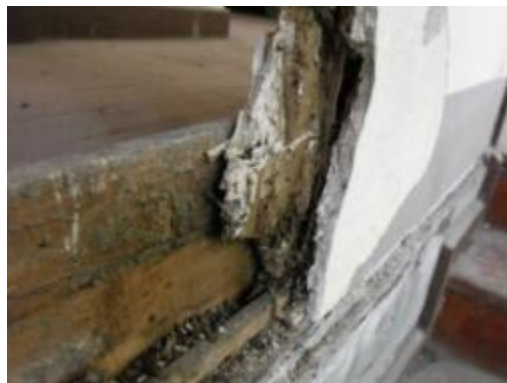
ภาพที่ ข.46 การแสดงแผ่นไม้ฉาบด้วยปูนโบราณเสียหายเนื่องจากปลวกกัดกินไม้ภายใน
