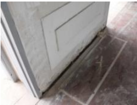
ภาพที่ 5.8 การแสดงความเสียหายที่ขอบพื้นไม้ เนื่องจากได้รับความชื้นจากผนังก่ออิฐรับแรง
