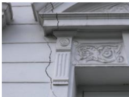
ภาพที่ 3.4 แสดงลักษณะผนังที่แตกกร้าวภายนอกอาคาร ชั้นที่ 2 อาคารวิภาคภูวดล
