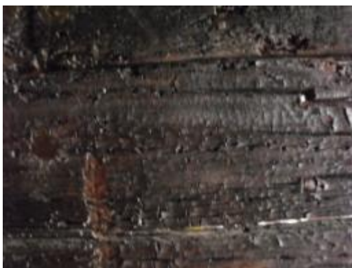
ภาพที่ 5.24 การแสดงผิวไม้เดิมผุเสียหายเนื่องจากความชื้น ไม่มีลักษณะไม่แข็งแรงและไม่ปลอดภัยต่อการใช้งาน
