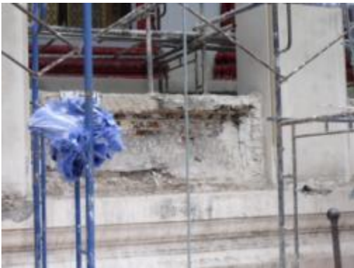
ภาพที่ 4.78 การแสดงปูนปั้นด้านนอกอาคาร ผุกร่อนเสียหาย
