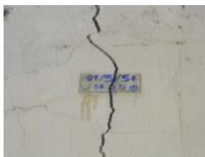
ภาพที่ 2.19 การแสดงติดตั้งกระจกกับผนัง เพื่อตรวจสอบการขยายตัวของรอยร้าว
