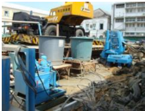
ภาพที่ 3.10 การแสดงลักษณะของอุปกรณ์ ขณะฉีดอัด Cement bentonite grout
