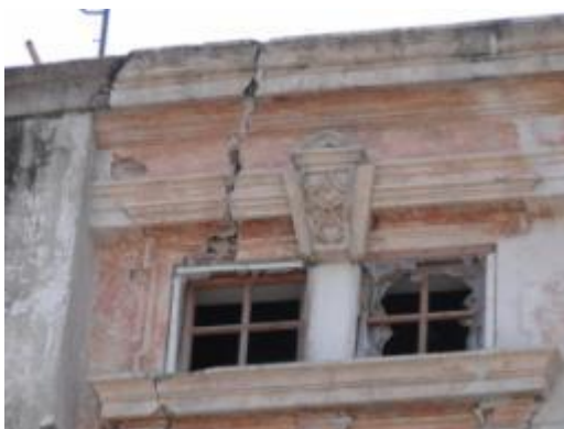
ภาพที่ 3.11 การแสดงรอยร้าวของผนังอาคารตำแหน่งรอยร้าวจากรางน้ำร้าวลงมาที่ผนังชั้นที่ 2
