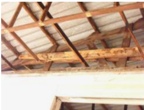
ภาพที่ ข.45 การแสดงลักษณะปลวกกัดกินไม้โครงหลังคา
