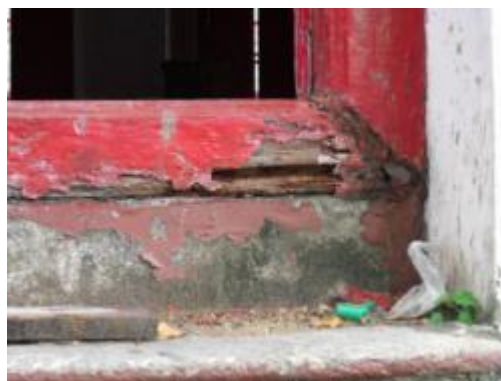
ภาพที่ 7.31 การแสดงวงกบไม้ผุเสียหายมากไม่สามารถซ่อมแซมได้
