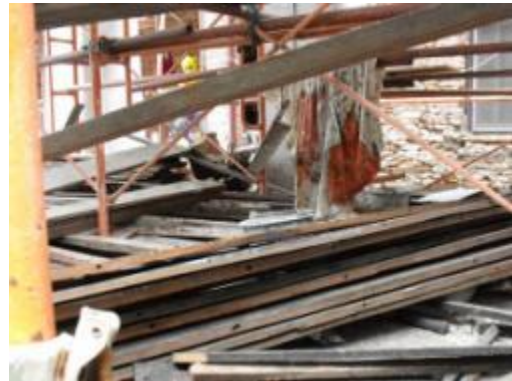
ภาพที่ ฉ.93 การแสดงไม้คานอะเสและ จันทันรีถอนออกไปเนื่องจากผุเสียหาย แล้ว เลือกลงใช้ไม้เดิมสภาพดีติดตั้งใหม่
