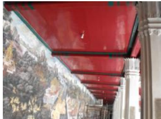
ภาพที่ จ.144 การแสดงทาสีจริงฝ้าเพดาน เพื่อเตรียมดำเนินงานปิดทองฝ้าเพดาน
