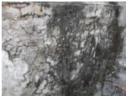
ภาพที่ 4.46 การแสดงเชื้อราดำเจริญเติบโตบนผนังและผนังมีรอยแตกร้าวลายงาที่ผิวผนัง
