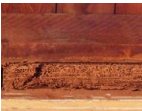
ภาพที่ ข.43 การแสดงลักษณะปลวกกัดกิน พื้นไม้และสร้างรังปลวกบนโครงสร้างไม้ ตรวจพบภายหลังจากการรื้อฝ้า
