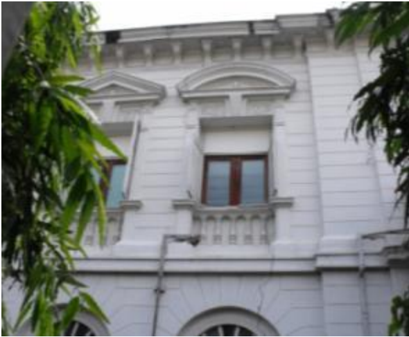
ภาพที่ 3.1 การแสดงรอยร้าวของผนังรับแรงอาคารวิภาคภูวดล ส่วนชั้นบน
