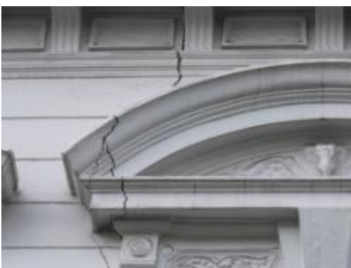
ภาพที่ 3.3 การแสดงลักษณะของรอยร้าวบนผนังภายนอกอาคารชั้นที่ 2
