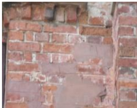
ภาพที่ 4.25 การแสดงผนังก่ออิฐเสียหายแต่ยังคงมีสภาพที่แข็งแรง
