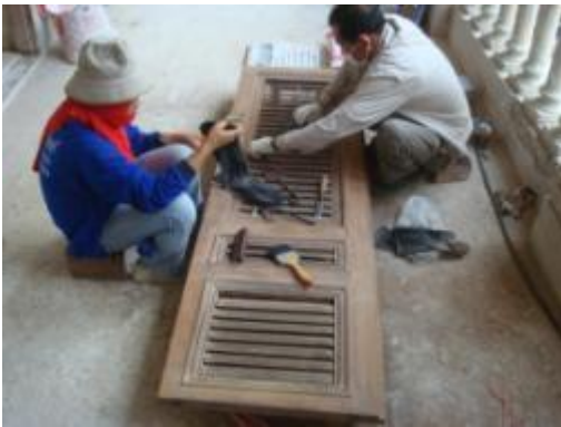
ภาพที่ ข.2 การแสดงขัดผิวไม้ ซ่อมแต่งไม้ และตอกยึดไม้ที่ประกอบเป็นบานประตูให้ แน่น
