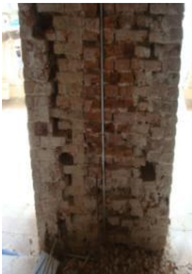
ภาพที่ 4.15 การแสดงความเสียหายของผนังอิฐร้าวในแนวตั้งก่อนอิฐแตกตามรอยร้าว
