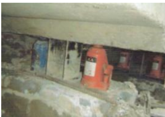
ภาพที่ ค.48 การแสดงลักษณะติดตั้งแม่แรงเตรียมยกอาคาร(ที่มา: บริษัทพีเนสส์ ซอยล์ เทสติ้ง จำกัด, 2551)
