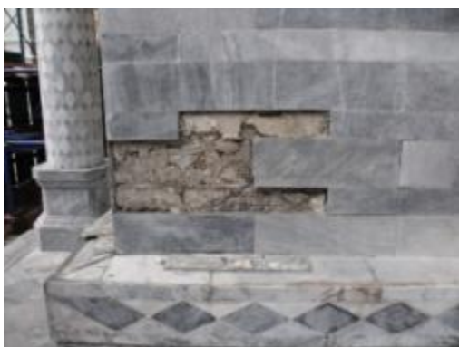
ภาพที่ 5.44 การแสดงหินอ่อนผนังหลุดร่วง เนื่องจากปูนสอเสื่อมสภาพ
