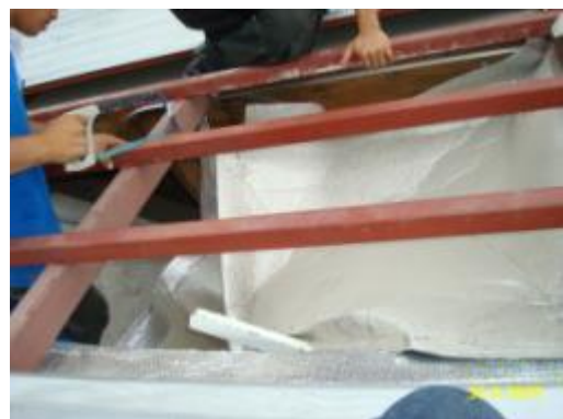
ภาพที่ ฉ.118 การแสดงติดตั้งโครงเหล็ก ทดแทนจันทันและแปไม้เดิมที่เสียหาย
