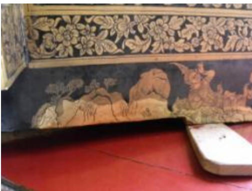
ภาพที่ ช.15 การแสดงบานประตูซ่อมลายรด น้ำใหม่เฉพาะด้านล่างประตูที่เสียหาย
