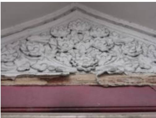
ภาพที่ 4.74 การแสดงปูนปั้นหลุดร่วงบริเวณ ที่ยึดกับไม้ด้านล่าง ตำแหน่งหน้าบ้านของ หลังคาอาคารโบราณสถาน
