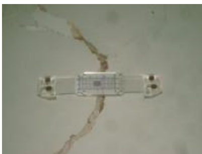
ภาพที่ 2.20 การแสดง Crack gauge ติดตั้งเพื่อตรวจสอบการขยายตัวของรอยร้าว
