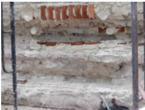
ภาพที่ ง.55 การแสดงโป๊วปูนตำแหน่งที่เสียหายมากก่อนดำเนินการฉาบผิวผนัง เนื่องจากการฉาบผิวที่มีความหนาจะทำให้ปูนฉาบแตกร้าว
