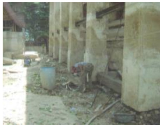
ภาพที่ ค.58 การแสดงเทคนิคกรีดยึดคอนกรีต รอบอาคาร (ที่มา: บริษัทพีเนสส์ ซอยล์ เทคโนโลยี จำกัด, 2551)
