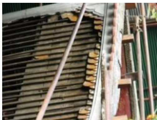
ภาพที่ 6.2 การแสดงหลังคาเดิมไม่ได้ติดตั้งแผ่นกันซึมน้ำฝนจึงรั่วเข้าภายในอาคารได้ง่าย
