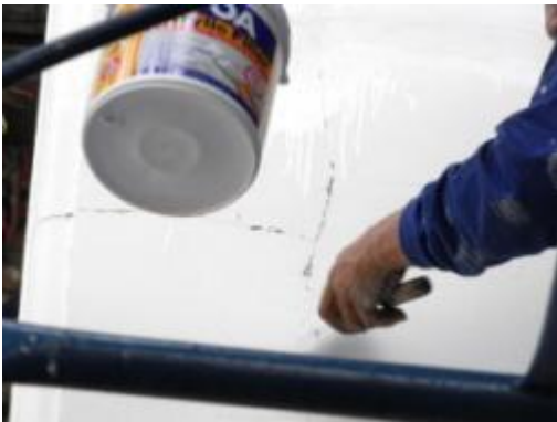
ภาพที่ ง.28 การแสดงโป๊วแต่งรอยร้าวด้วย เคมีภัณฑ์โป๊วแต่งผิวและปกปิดรอยร้าว
