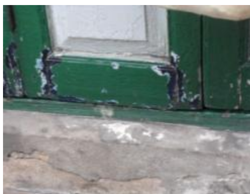
ภาพที่ 7.5 การแสดงสีเดิมเสียหายและบาน ประตูยึดประกอบไม่แน่น
