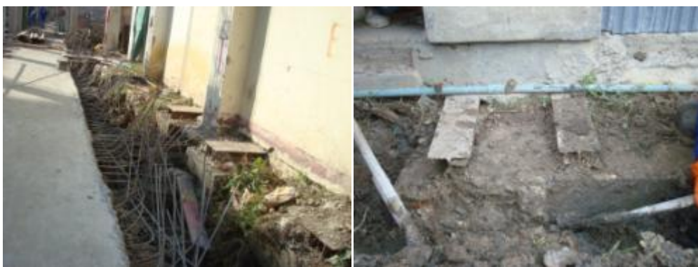
ภาพที่ 4.12 การแสดงคานเหล็กรูปพรรณบูรณะรับน้ำหนักอาคารโบราณสถานอยู่ในตำแหน่งที่มีความชื้นสูงมีสภาพผุกร่อนเสียหาย
