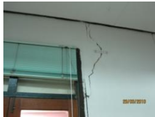
ภาพที่ ค.2 การแสดงภาพการติดตั้ง Crack gauge บนผนังอาคารโบราณสถาน
