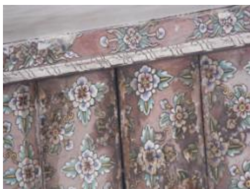
ภาพที่ 6.19 การแสดงฝ้าเพดานมีร่องรอยผุเล็กน้อยและมีคราบน้ำเนื่องจากหลังคารั่ว
