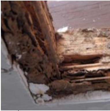
ภาพที่ 4.7 การแสดงลักษณะวงกบไม้รับ บานหน้าต่างและผนังก่ออิฐด้านบนมีปลวก กัดกินจนเสียหายทั้งหมด
