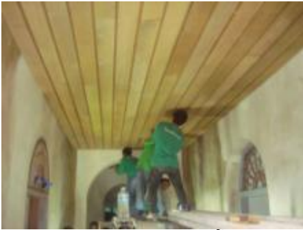
ภาพที่ ฉ.163 การแสดงติดตั้งฝ้าเพดานด้วยไม้ใหม่ทั้งหมด
