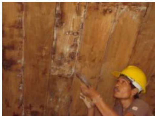
ภาพที่ ฉ.151 การแสดงตรวจสอบและตอกยึดไม้กระดานฝ้าเพดานให้แน่นมั่นคง
