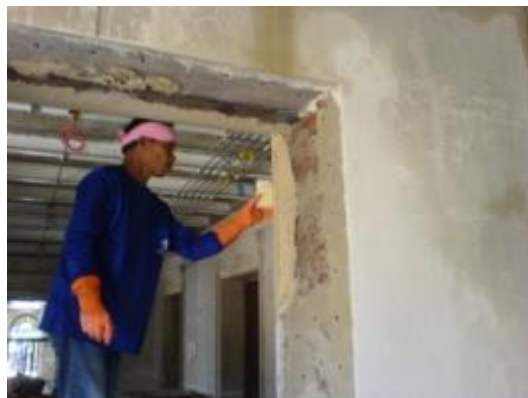
ภาพที่ ง.11 การแสดงฉาบปูนตกแต่งปิดหุ้ม เหล็กรูปพรรณที่เสริมแทนไม้เดิมที่ผู้
