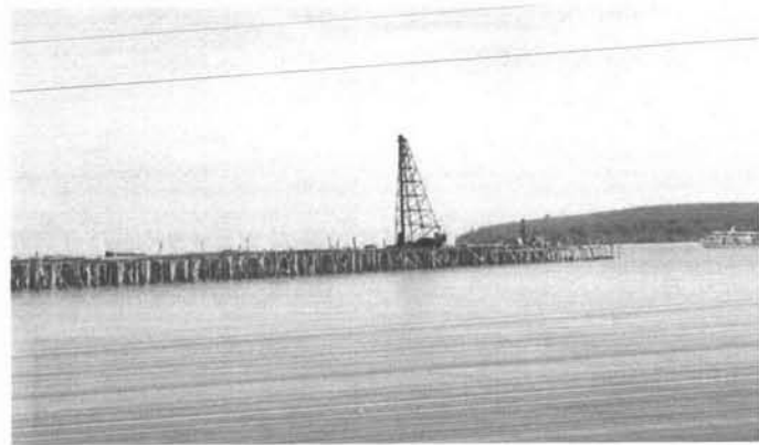
ภาพที่ 5.13 สภาพท่าเรือใหม่ที่อยู่ในระหว่างก่อสร้าง
