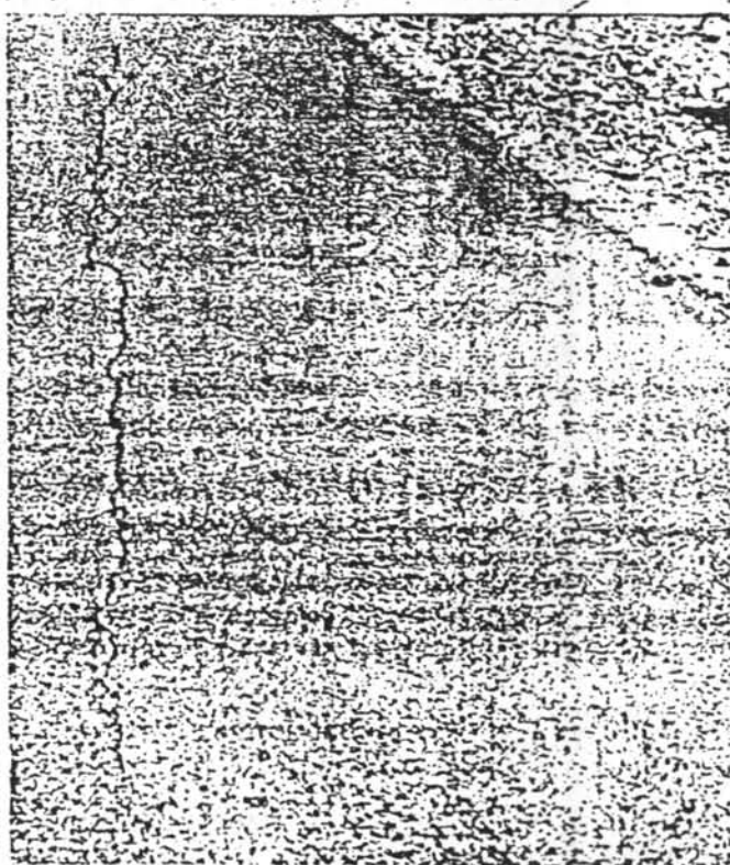
รูปที่ ช.8 รอยแตกกว้างจากการขยายผิวทาง (Widening Cracks)
