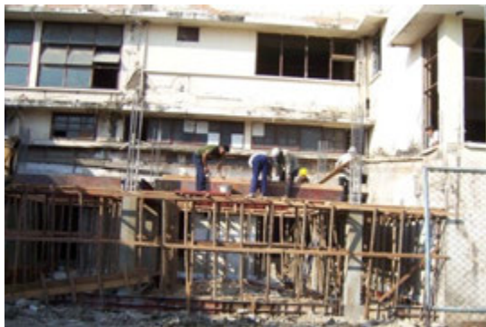
รูปที่ 4-34 ก่อสร้างอาคารต่อเติมด้านหลัง
