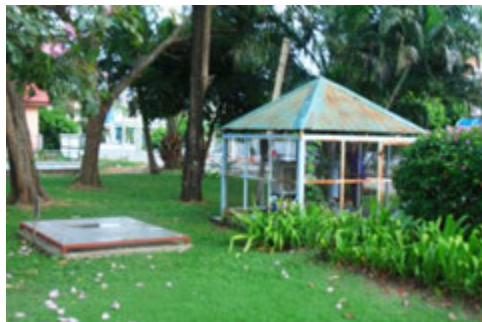
ภาพที่ 5.102 แสดงบ่อบำบัดน้ำเสียในโครงการสัมมากร รังสิต คลอง 7
