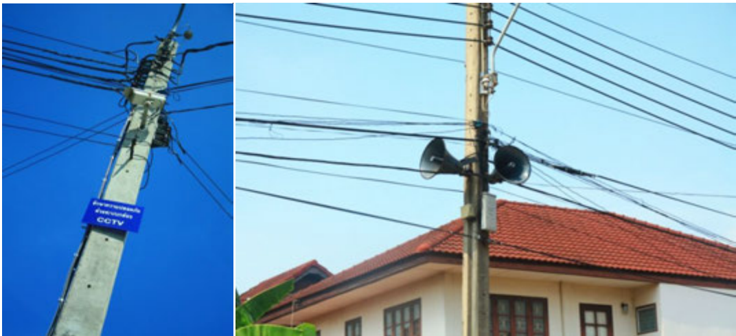
ภาพที่ 5.55 แสดงกล้อง cctv และ ลำโพงกระจายเสียงโครงการสัมมากร นิมิตใหม่
